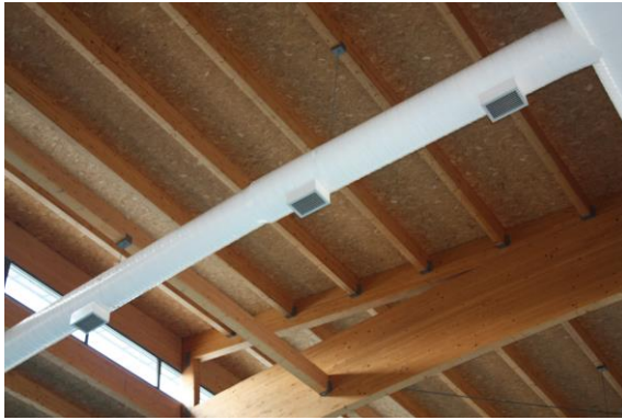
Figura 24: Grelhas que fornecem ar à envolvente das piscinas
