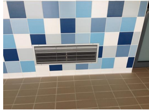
Figura 23: Grelhas que extraem o ar à envolvente das piscinas
