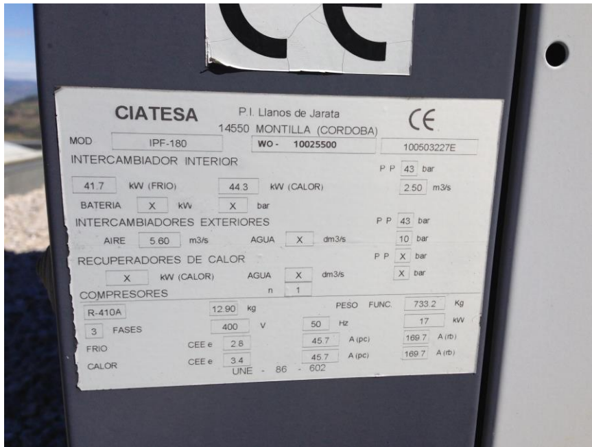
Figura C. 1: Imagem do Chiller instalado nas Piscinas Municipais de Armamar
