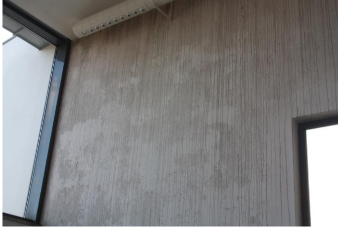
Figura 10: Humidade Existente nas paredes do edifício.
