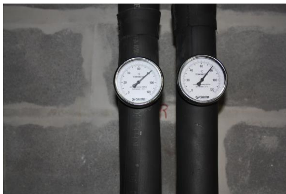
Figura 11: Leitores de Temperatura de uma das bombas que fornece águas quentes ao edifício em estudo.
