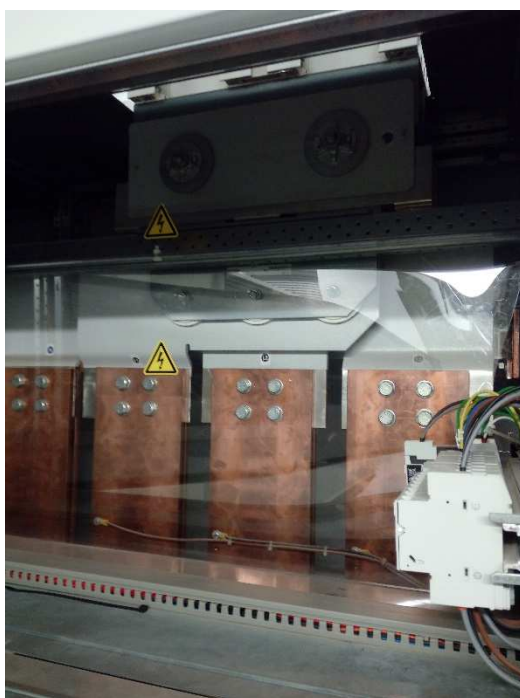
Figura 55 – Ligação do Busbar ao quadro elétrico
