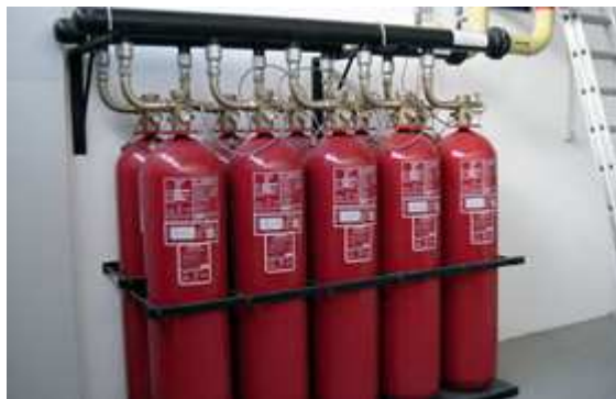
Figura 39 - Sistema mecânico de armazenamento do agente extintor [19].
