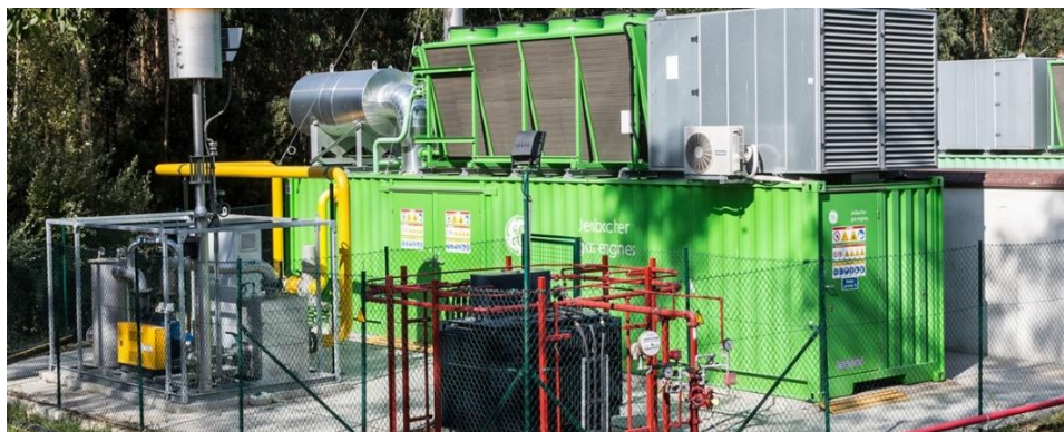
Figura 4 - CVEB da Suldouro (ENC Energy, 2016)
