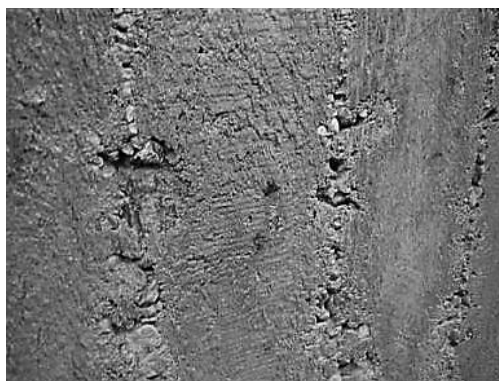
Fig. 2.15 – Danos no betão devido ao seu vazamento através da cofragem
