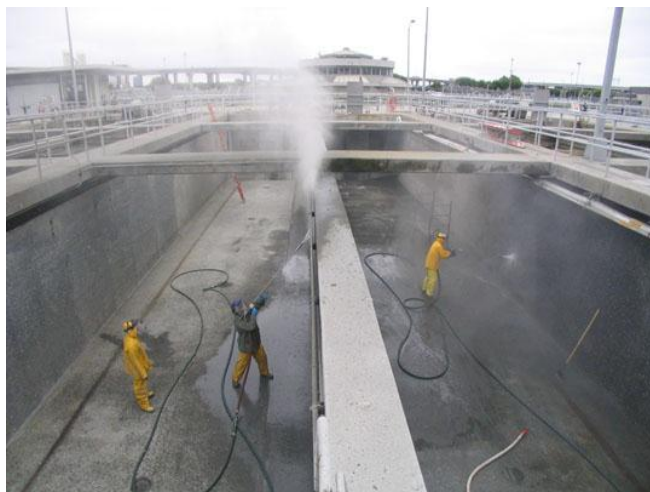
Fig. 5.3 – Exemplo de uma limpeza da superfície de betão armado com jato de água
