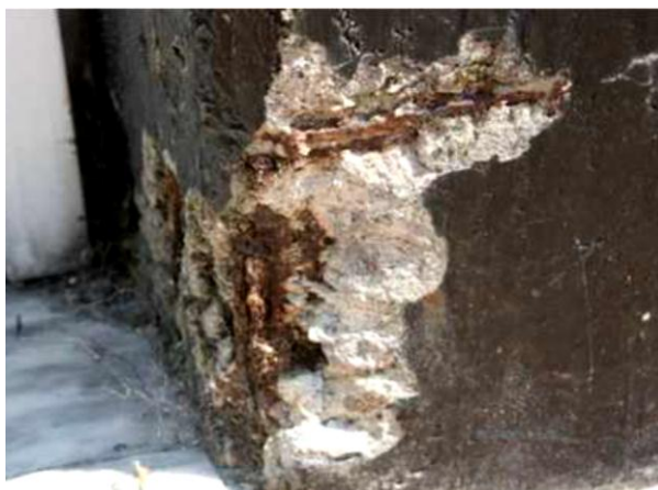
Fig. 2.4 – Corrosão de armaduras num pilar
