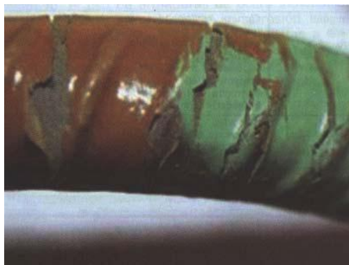
Fig. 5.17 – Corrosão devido a rotura do filme de resina numa armadura
