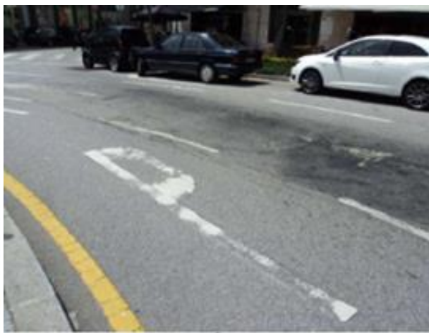
Figura 7.45 – Deformação no pavimento em mistura betuminosa na Praça dos Poveiros (2015)
