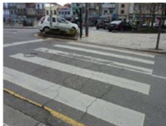
b) Fendilhamento na travessia
