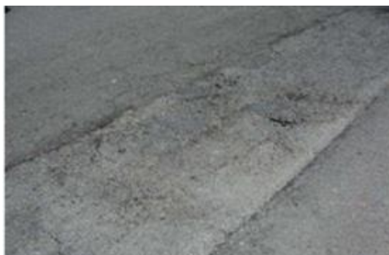
Figura 7.46 – Deformação e desagregação do pavimento em mistura betuminosa na zona de infraestruturas (2015)
