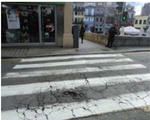
Figura 7.44 – Ninhos no pavimento em mistura betuminosa no extremo da Rua de Santo Ildefonso, junto à Praça dos Poveiros (2015)
