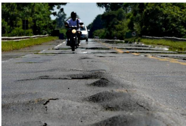
Figura 4.1 – Exemplo de deformação excessiva (Farina, 2015)
