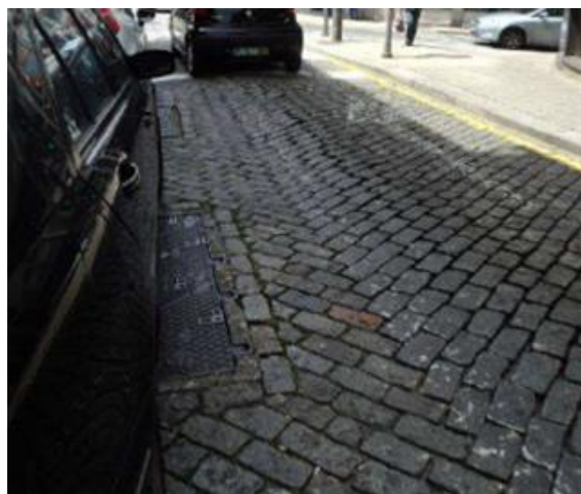
Figura 7.38 – Degradação do pavimento da Rua de Santo Ildefonso (2015)
