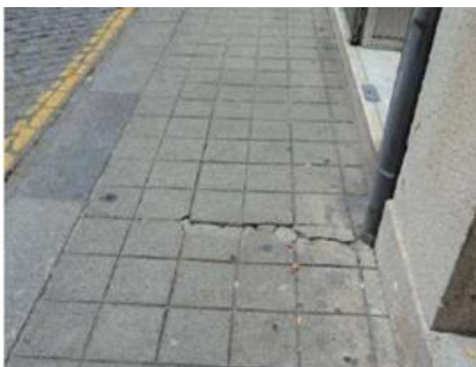
Figura 7.52 – Betonilha esquartelada na Rua de Santo Ildefonso
