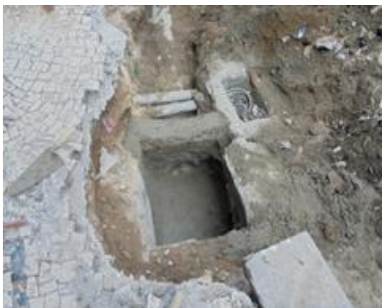
Figura 7.29 – Abertura de caixa (2015)
