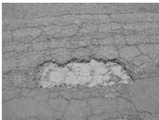
Figura 4.3 – Desagregação da camada de desgaste (2015)
