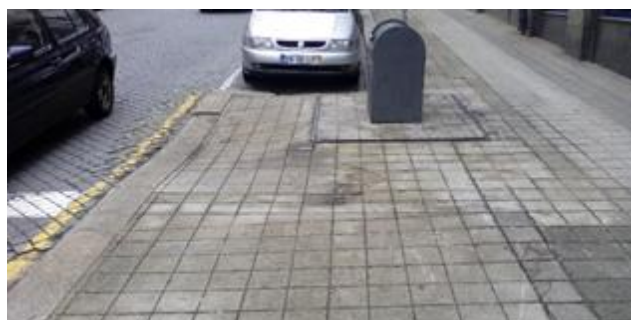
Figura 7.21 - Abatimento do pavimento junto ao “city-trainer” (2015)
