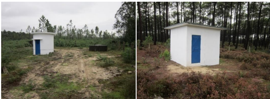
Figura 3-13- Captação do Carregal- Furos JK3 e JK4 (Fonte: AdDP)
