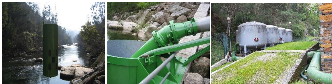
Figura 3-20- Grupo eletrobomba portátil e filtros de pré-tratamento (Fonte: AdDP)
