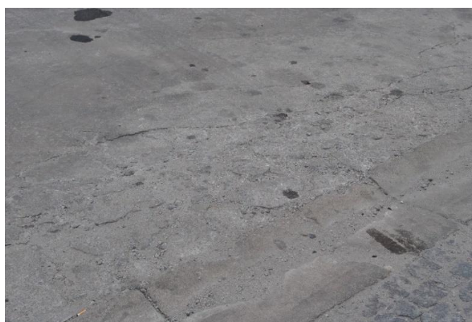
Figura 4.16 - Desagregação da camada superficial de um Pavimento Rígido (2017)
