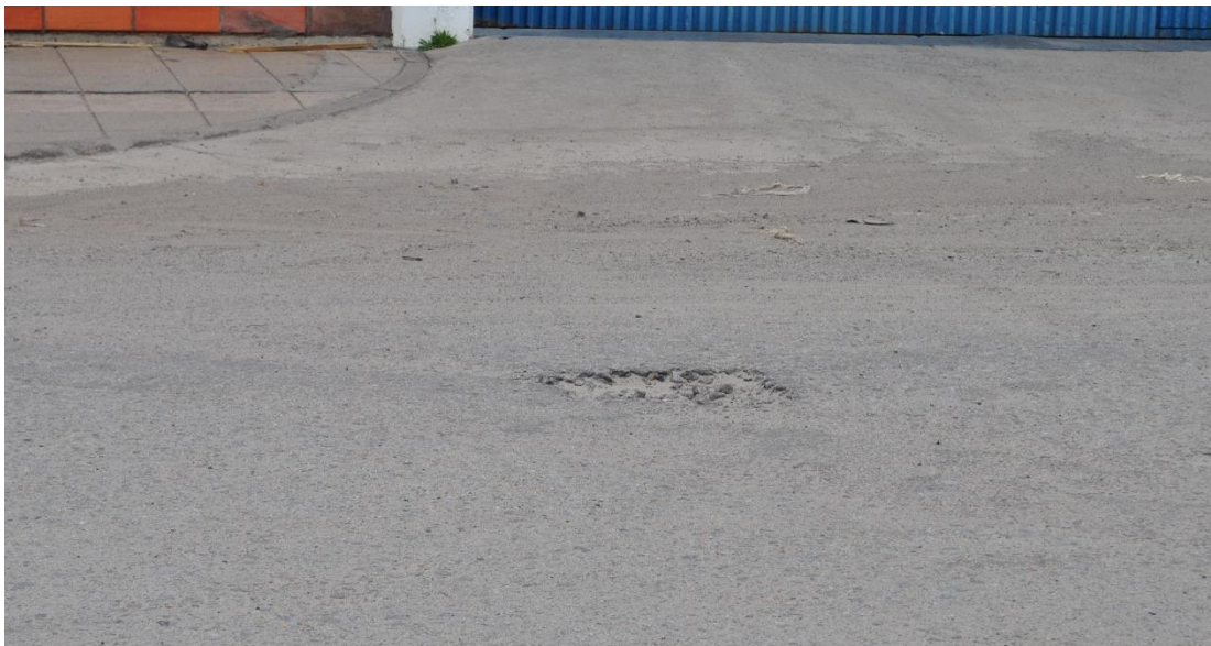
Figura 4.12 - Desagregação da camada de desgaste (2017)
