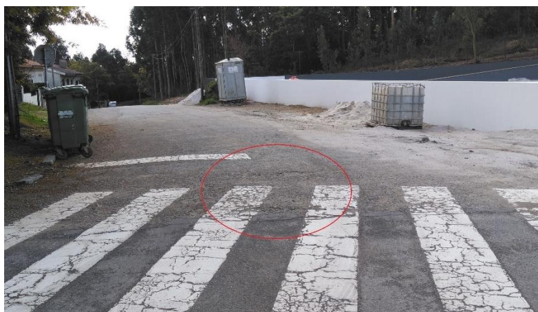
Figura 4.3 - Deformação Localizada na Rua Fernando Pinto Lourenço (2018)
