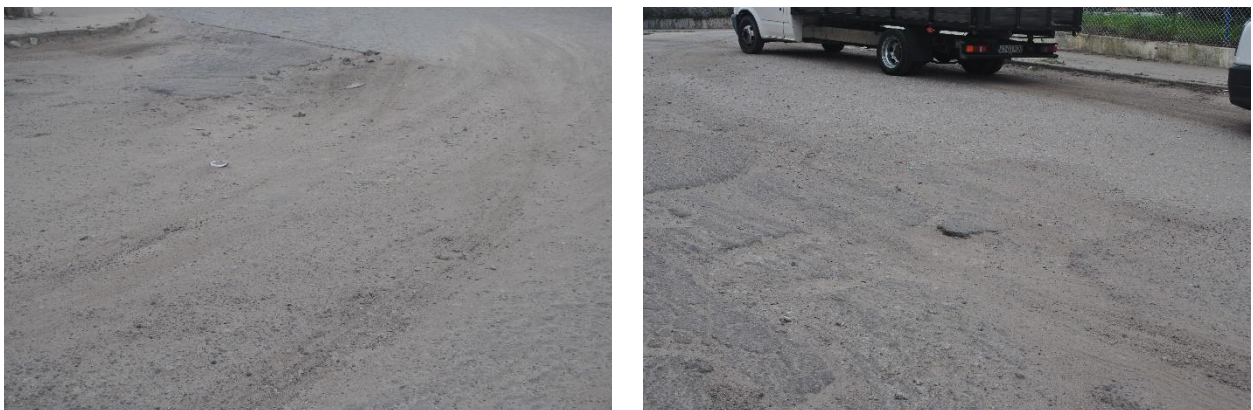
Figura 4.1 - Exemplo de pavimentos com patologias (2017)
