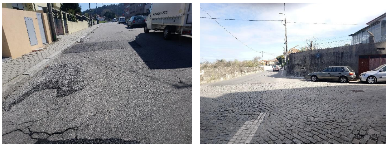
Figura 5.6 - Pavimento atual da Rua da Chavinha d'Água e da Rua Delfim de Lima (2018)
