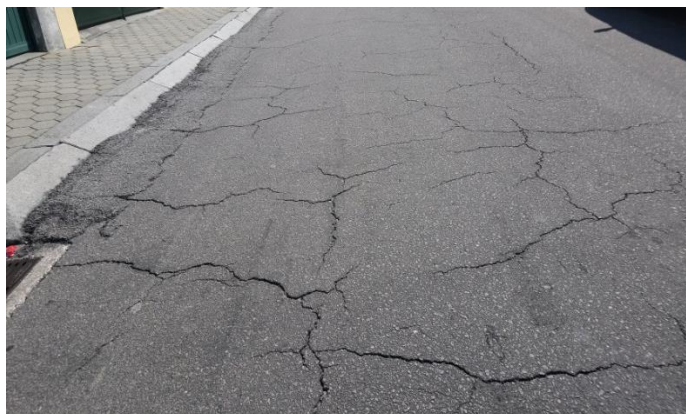
Figura 4.8 - Fendas por fadiga (2018)
