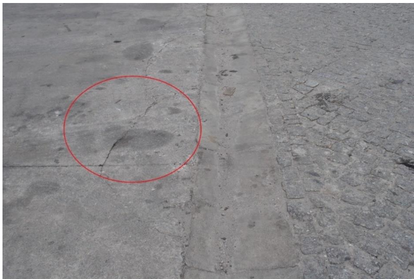
Figura 4.15 - Fendilhamento em Pavimento Rígido (2017)
