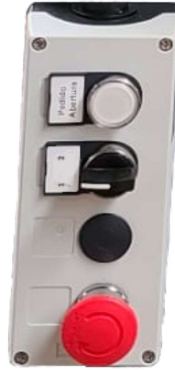
Imagem 15: Caixa de comando alimentador
