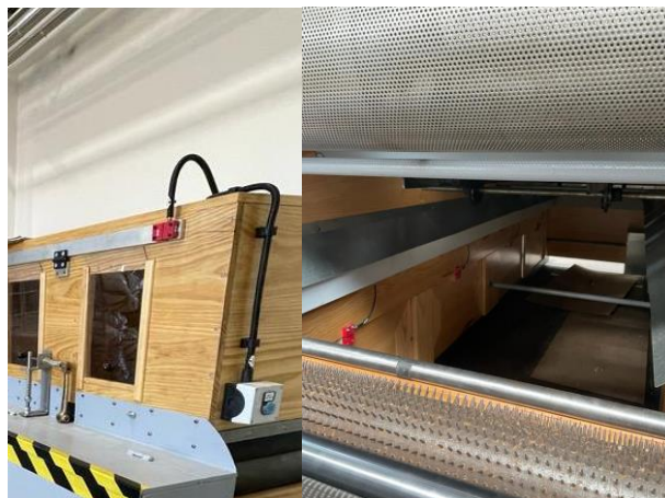
Figura 36- Sensores magnéticos aplicados em elementos de proteção móveis.
