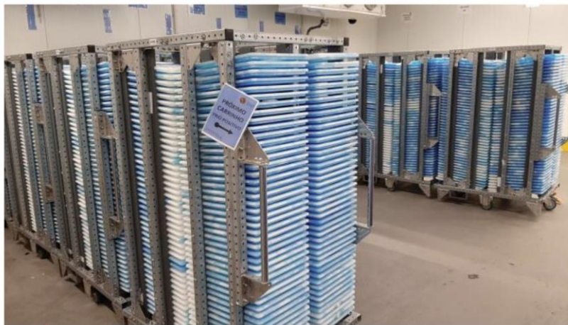
Figura 11 - Dolis de placas eutéticas colocados dentro da arca de congelação
