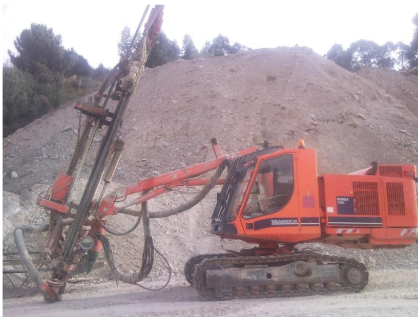
Figura 18-Equipamento de perfuração: Tamrock Ranger 700.
