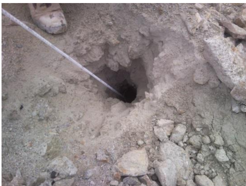
Figura 24-Emboquilhamento em mau estado.
