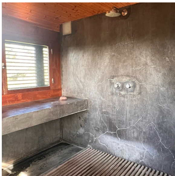
Figura 79 – Parede de betão da casa de banho.
