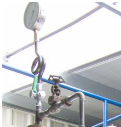
Figura 59 – Manómetro, torneira, sifão, válvula de cunha (T1), ver figura 50.
