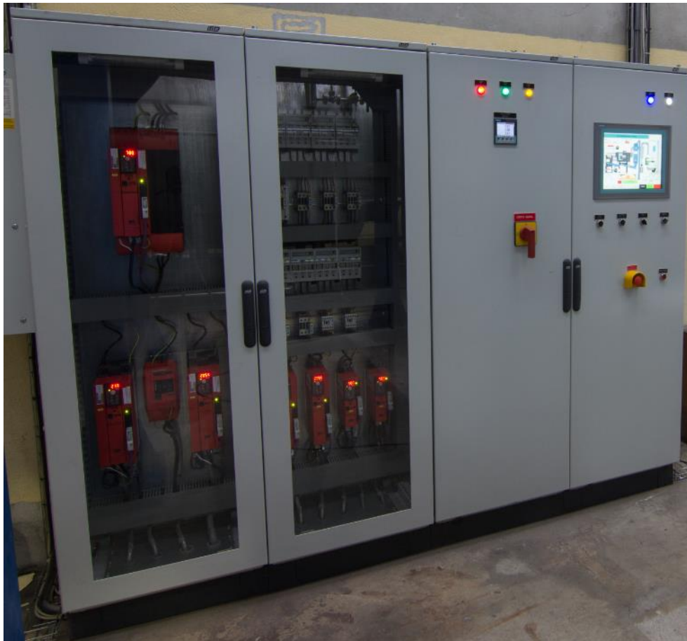
Figura 112 – Quadro de comando.
