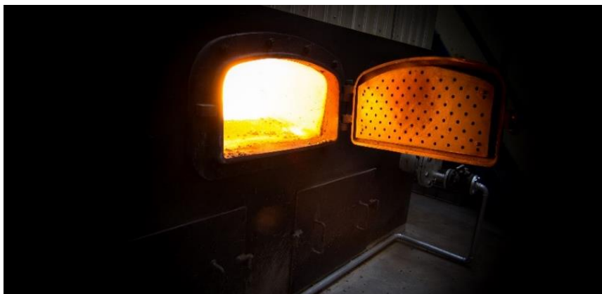
Figura 109 – Abertura da porta sem perigo de saída de fogo.
