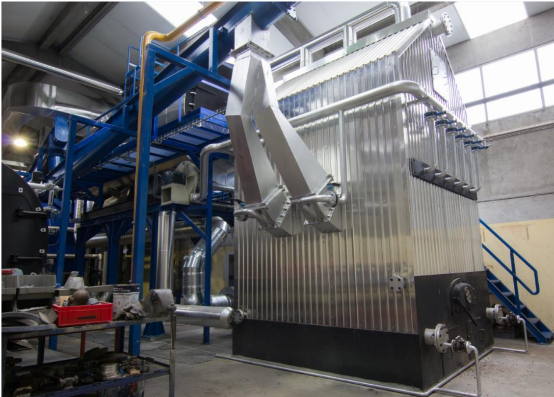
Figura 5 – central de vapor a péletes.
