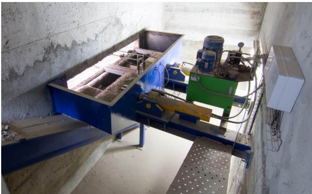
Figura 10 – Zona de descarga do arrastador.
