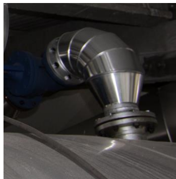
Figura 62 – Válvula de globo (vapor) (T5), ver figura 50.
