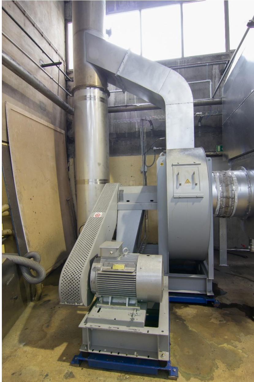
Figura 111 – Ligação do ventilador ao economizador/chaminé.
