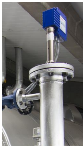
Figura 54 – Controlador de nível (T8), ver figura 50.
