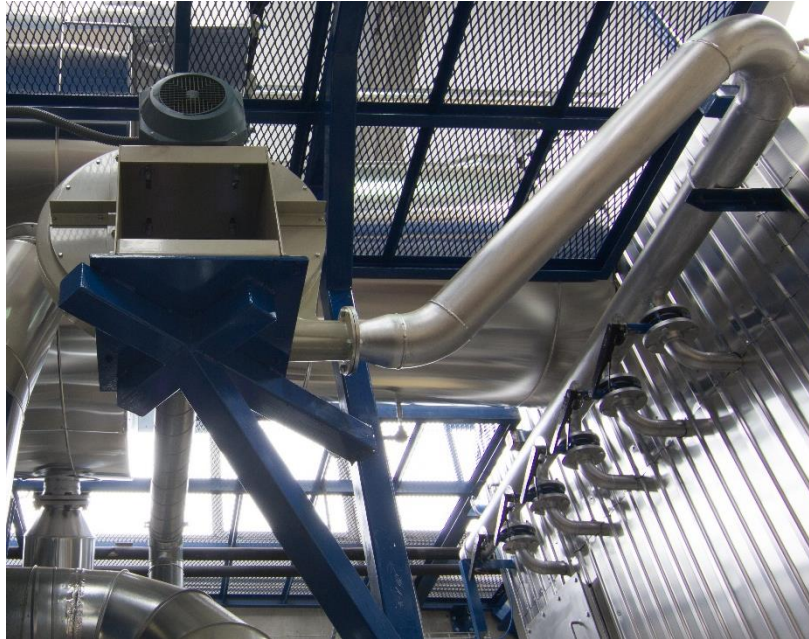
Figura 108 – Ventilador a insuflar ar na traseira da ante-fornalha.
