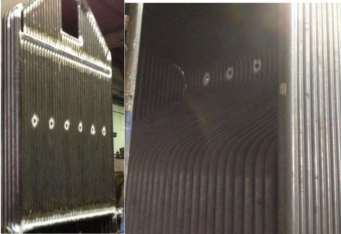
Figura 106 – Parede frontal e traseira da ante-fornalha.
