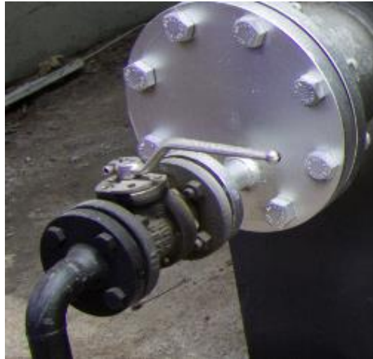
Figura 36 – Válvula de seccionamento.
