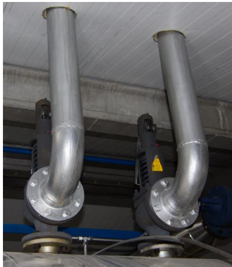
Figura 60 – Válvulas de segurança (T4), ver figura 50.
