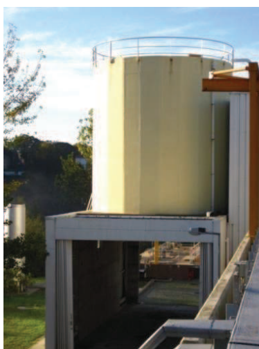
FIGURA 25: Silo de armazenamento de lamas
