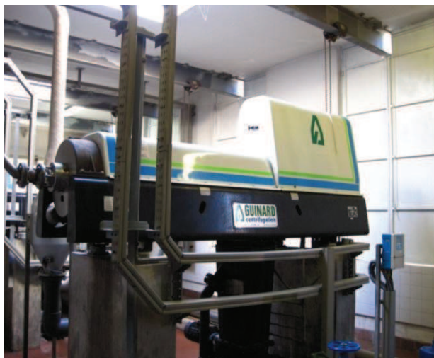
FIGURA 22: Centrifugas de espessamento
