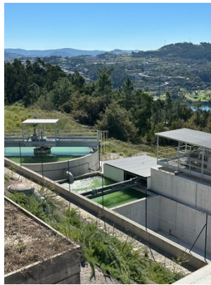
Figura 13 - Estação tratamento água SPM (fonte: criação própria)
