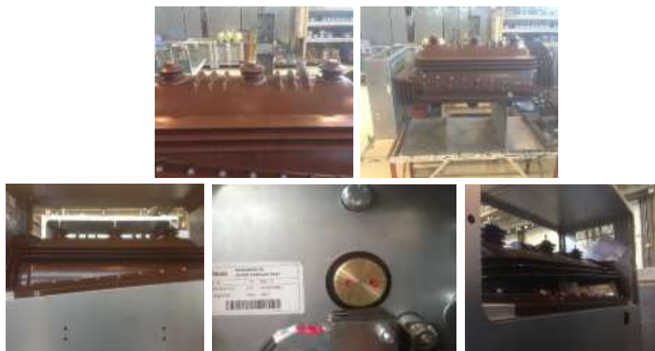
Figura 55 Ampola de isolamento a SF 6 e respetiva tampa de enchimento.
