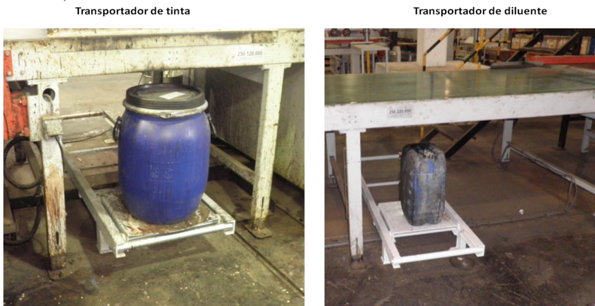
Figura 28 – Sistema de transporte de tinta e diluente
