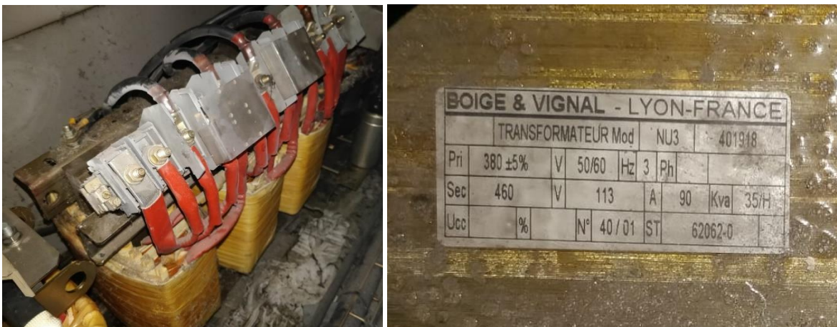
Figura 32 – a) Transformador 380/460V, b) Chapa de características do transformador
