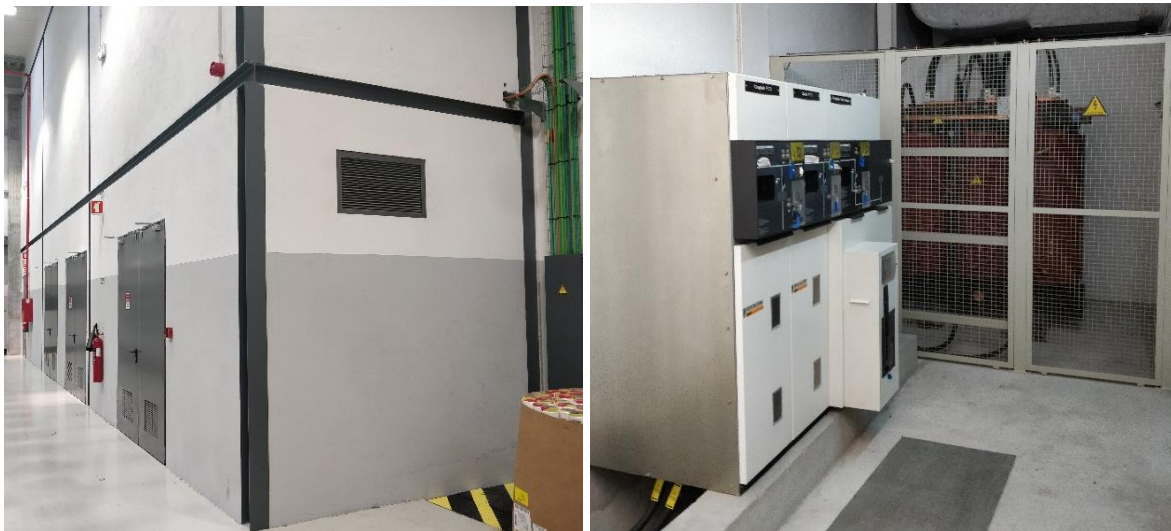
Figura 11 - a) Edifício de posto de transformação 4; b) Zona dos quadros de MT e transformador 4.1
