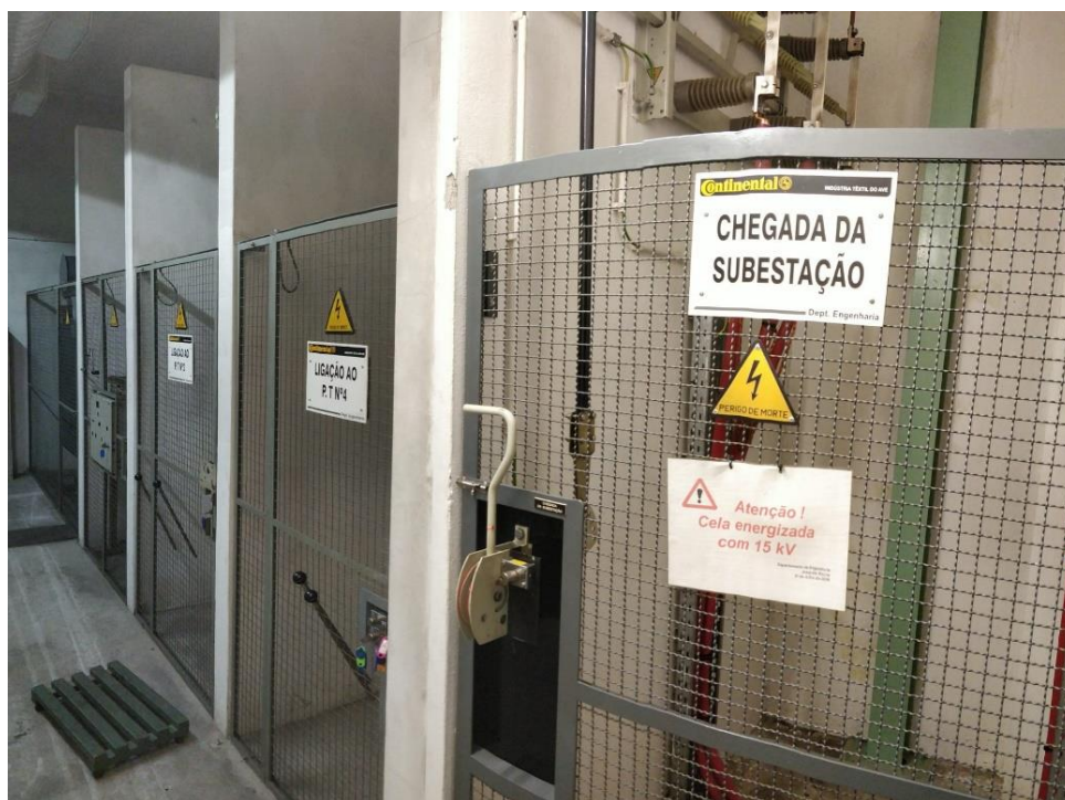
Figura 16 - Cella seccionamento em alvenaria do PT3
