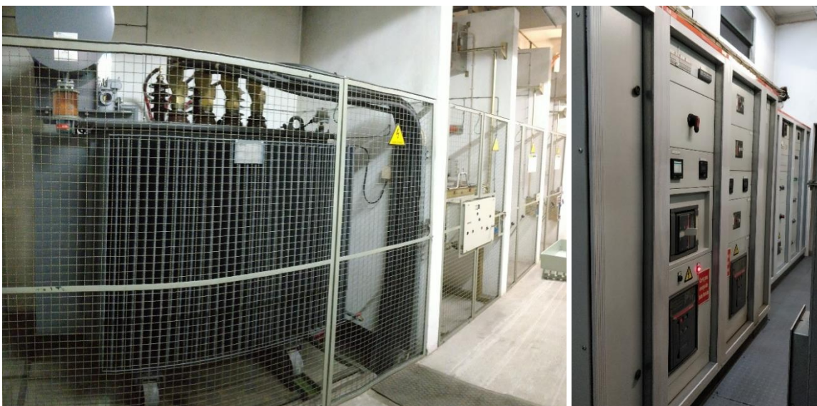
Figura 10 - a) Zona de MT e transformador a óleo 3.1; b) Quadro geral de baixa tensão 3.1
