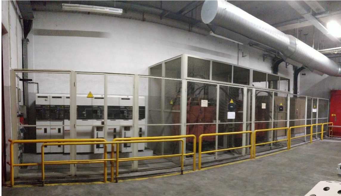
Figura 9 -Vista geral do PT2
