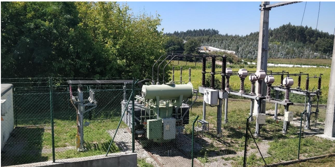
Figura 13 - Subestação 60/15kV da Continental - Indústria Têxtil do Ave S.A.
