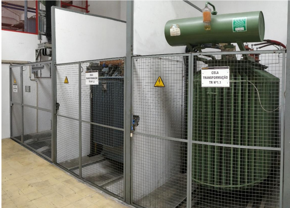
Figura 8 - Transformadores do posto de transformação 1
