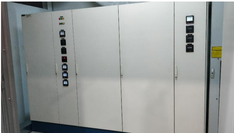
Figura 12 - Quadro geral de baixa tensão 4.1
