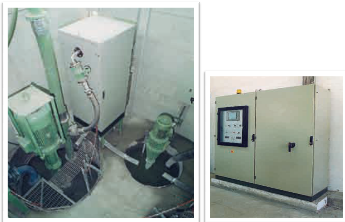
Figura 8 Poço principal de mistura e sistema de controlo do engenho
