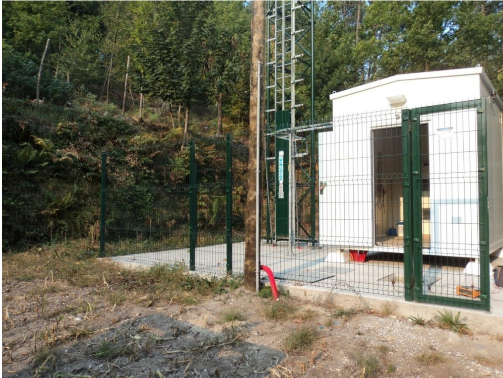
Figura 2.2 - ET do tipo Greenfield
