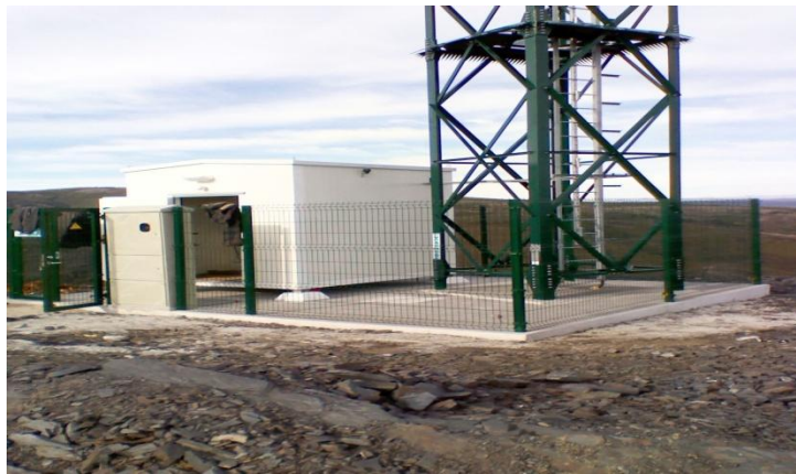
Figura 2.7 – Contentor, torre de telecomunicações e laje
