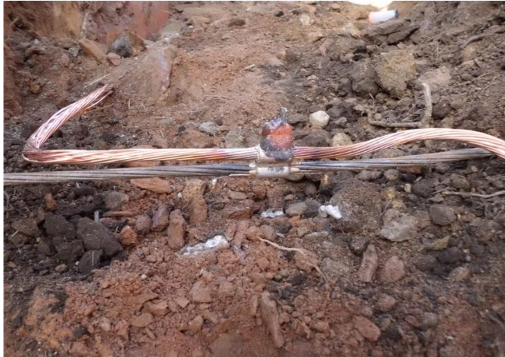
Figura 3.2 – União de cabo de cobre após processo de soldadura
