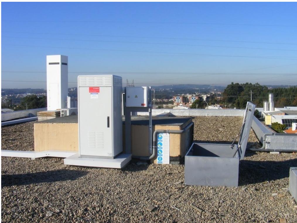
Figura 2.3 – ET do tipo Rooftop
