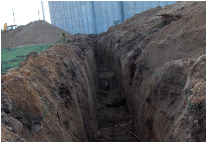
Figura 3.3 – Vala com chapa de cobre interligada ao cabo de cobre
