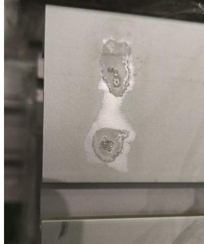
Figura 11 - Defeitos nas extremidades dos perfis de alumínio
