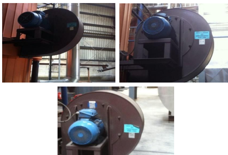
Figura 4. 1 -Representação fotográfica dos três ventiladores utilizados na caldeira de tubo de fumos de 4,0 MW. Encontram-se representados o ar primário, secundário e terciário respetivamente.
