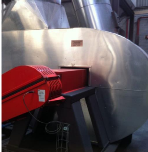
Figura 3. 5- Exemplo de um ventilador de tiragem forçada utilizado numa casa das caldeiras.
