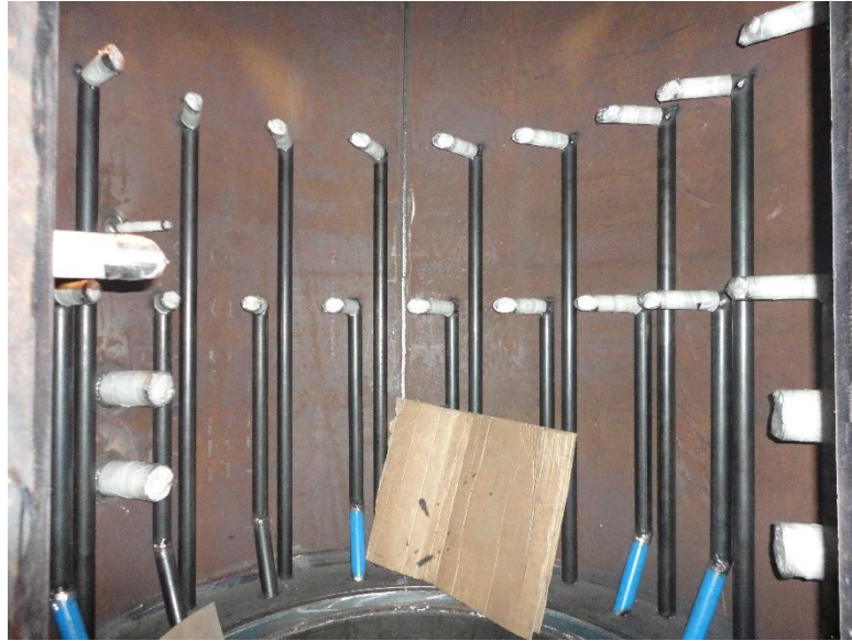
Figura 4. 6- Visualização dos tubos de 0,052 metros de diâmetro onde sai o ar secundário e os tubos de ar terciário de maior comprimento.
