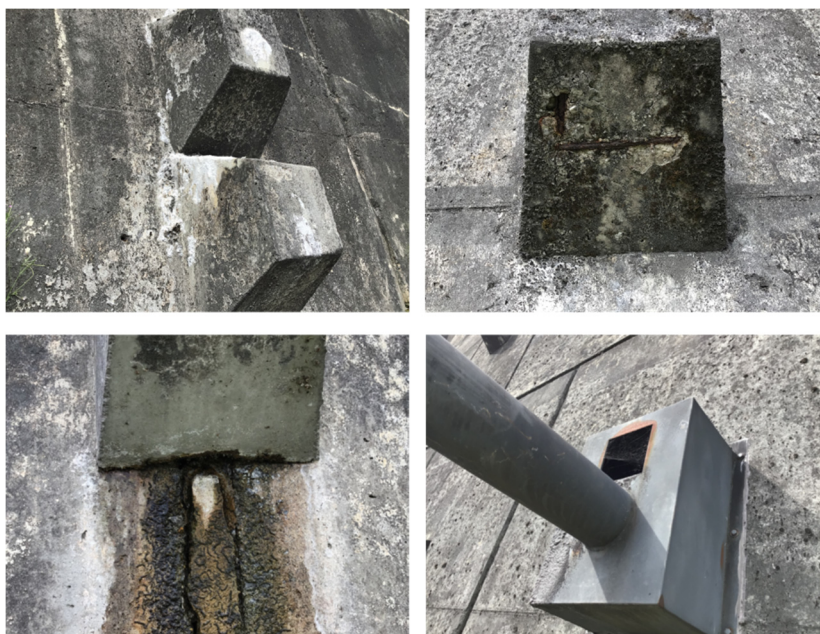
Figura 27 - Exemplos de patologias registadas no decorrer da inspeção visual ao muro M02.
