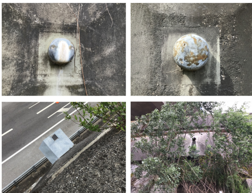
Figura 34 - Exemplos de patologias registadas no decorrer da inspeção visual ao muro M07.
