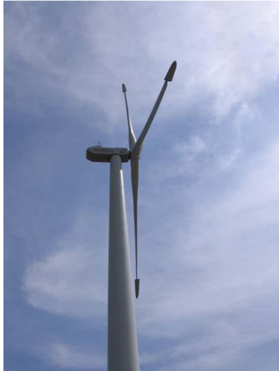
Figura 10 – Aerogerador utilizado no Parque eólico da Bulgueira, Nordex N50/800.
