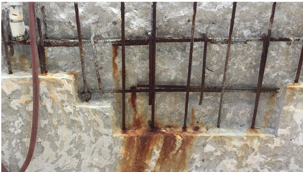
Figura 96 – Exemplo de Aplicação 1 (Corrosão) – Imagem Original.
