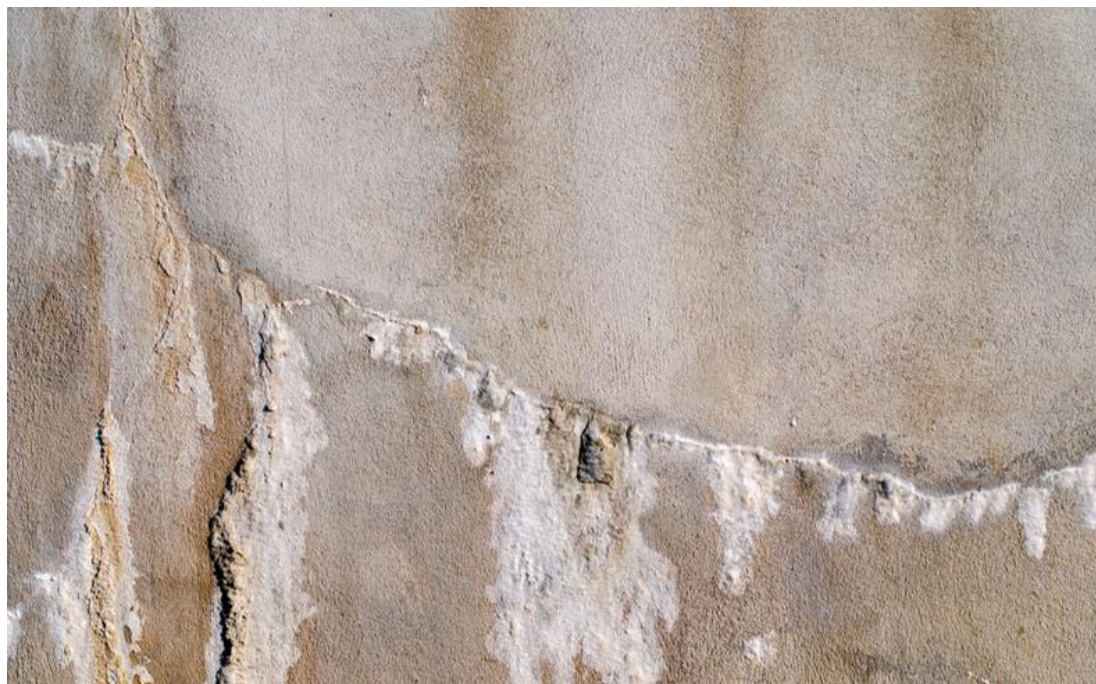
Figura 92 – Exemplo de Aplicação 2 (Eflorescências) – Imagem Original.
