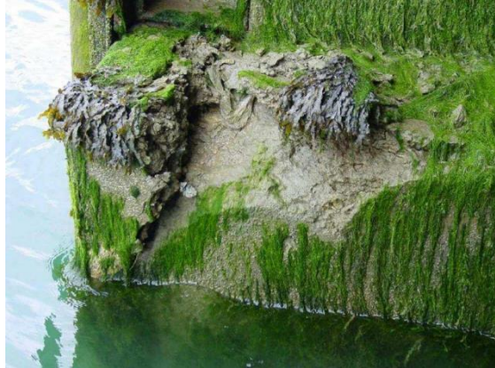
Figura 21 – Ação de algas em elemento de betão armado. (Saraiva, 2007)
