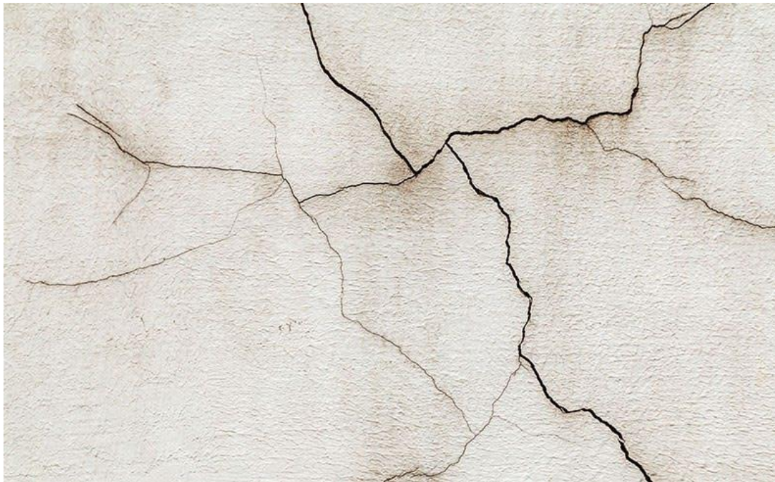
Figura 76 – Exemplo de Aplicação 1 (Fissuras) – Imagem Original.
