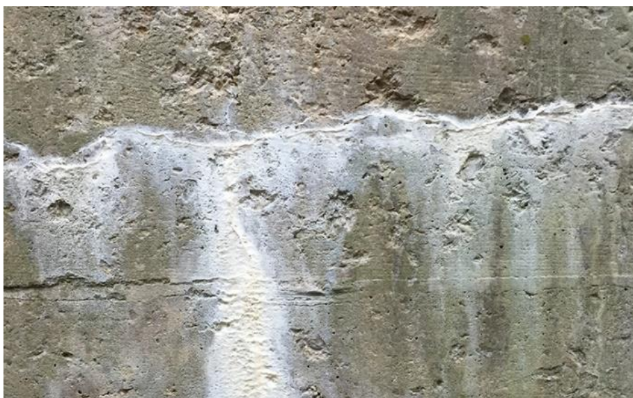
Figura 90 – Exemplo de Aplicação 1 (Eflorescências) – Imagem Original. (Sabai, 2017)
