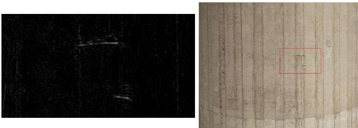
Figura 124 – Detecção de armaduras expostas.
