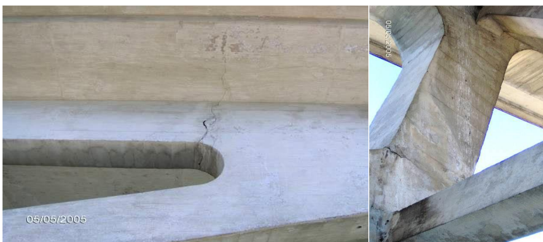
Figura 24 – Fissuração resultante de erros de dimensionamento. (Costa, 2011b)
