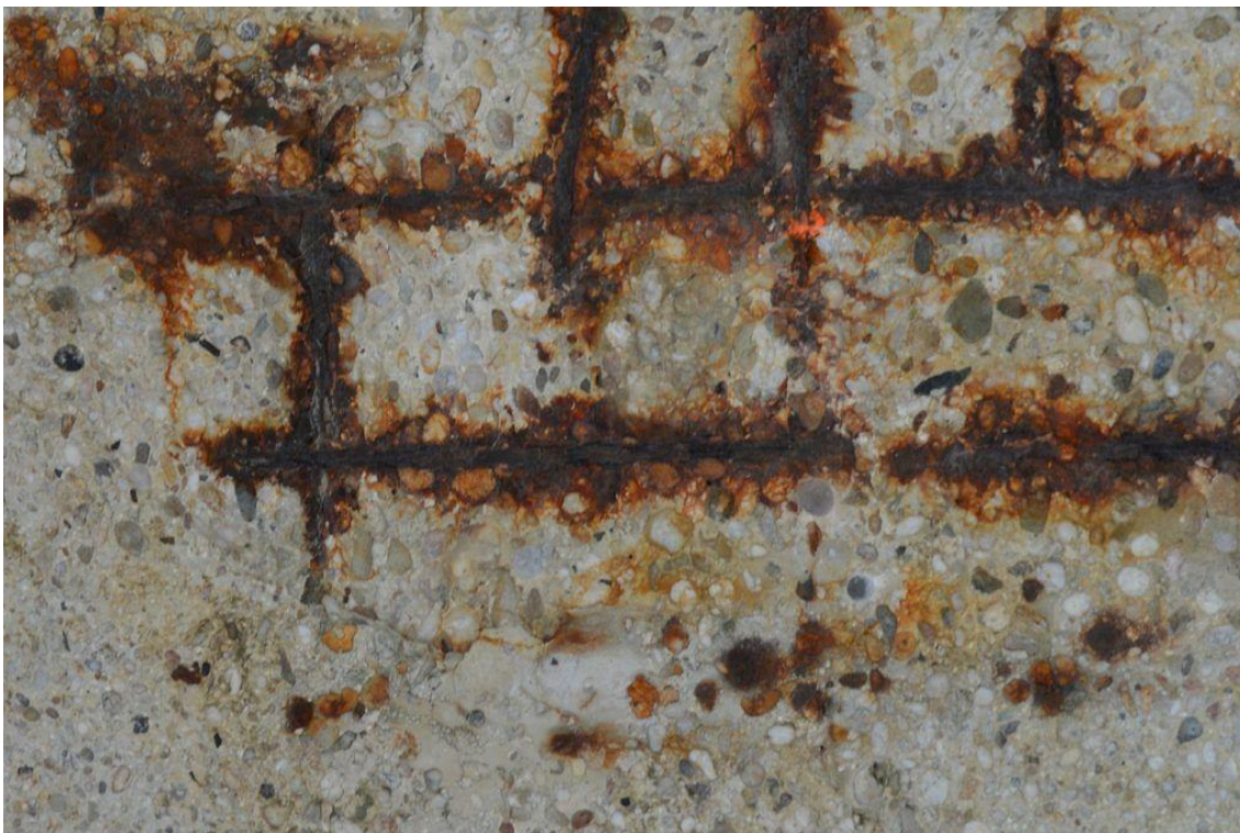
Figura 98 – Exemplo de Aplicação 2 (Corrosão) – Imagem Original.
