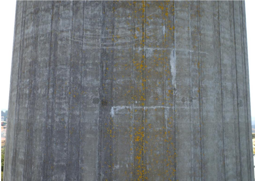
Figura 132 – Aplicação da ferramenta de detecção de eflorescências – Imagem Original.
