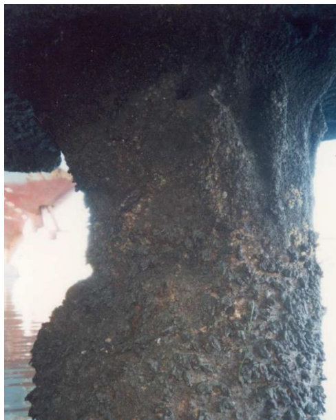
Figura 22 – Ação de moluscos em elemento de betão armado. (Saraiva, 2007)
