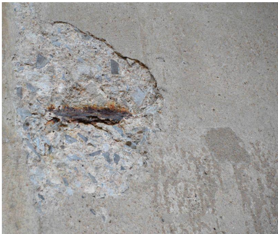
Figura 100 – Exemplo de Aplicação 3 (Corrosão) – Imagem Original.
