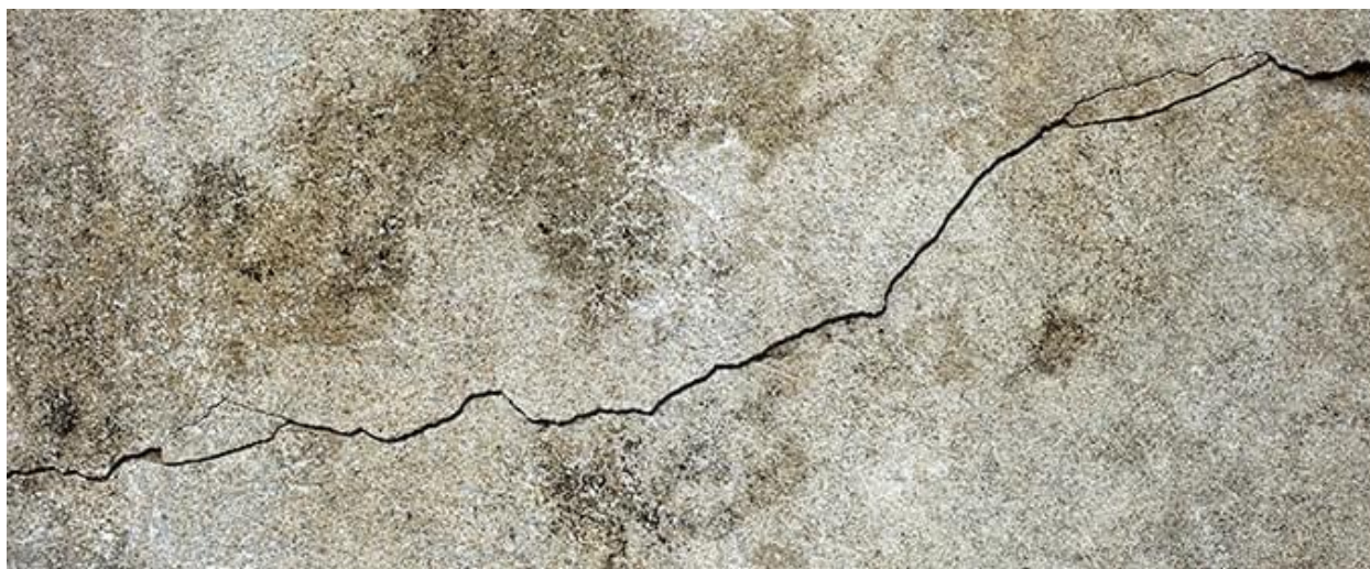
Figura 80 – Exemplo de Aplicação 3 (Fissuras) – Imagem Original.
