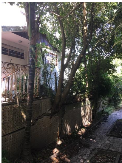
Figura 23 – Ação de raízes em muro de contenção.
