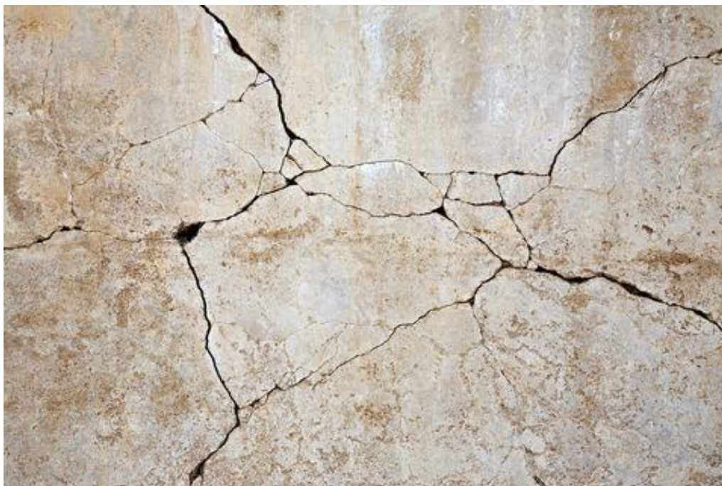
Figura 78 – Exemplo de Aplicação 2 (Fissuras) – Imagem Original.
