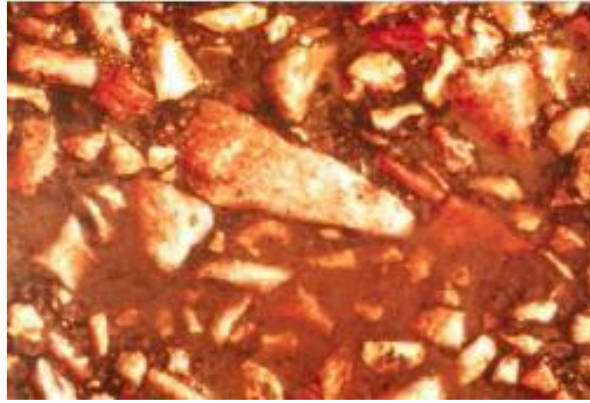
Figura 18 – Elemento de betão com sinais de erosão. (Gomes, 2016)
