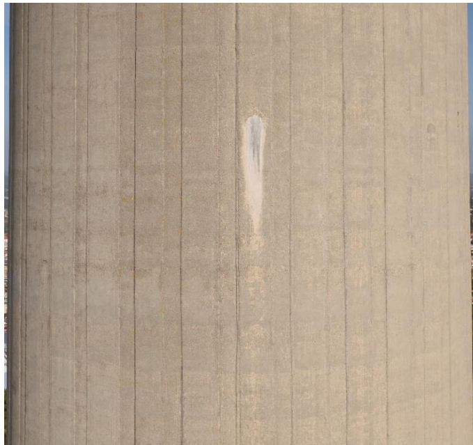
Figura 130 – Aplicação da ferramenta de detecção de eflorescências – Imagem Original.
