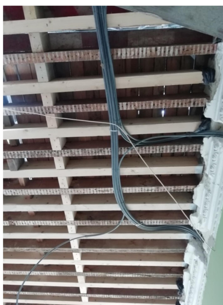
Figura 3.42 - Cabos da rede de eletricidade
