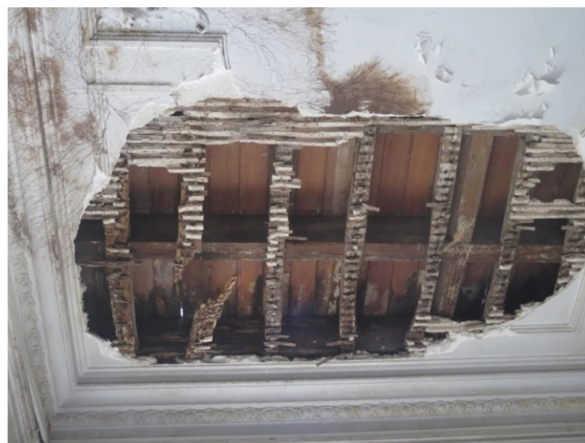
Figura 3.16 - Estado da estrutura do pavimento (vista inferior) (NCREP, 2017)
