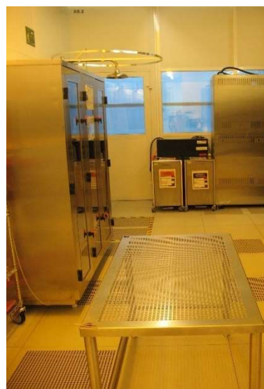
Figura 32 - Armário N2 em bom funcionamento
