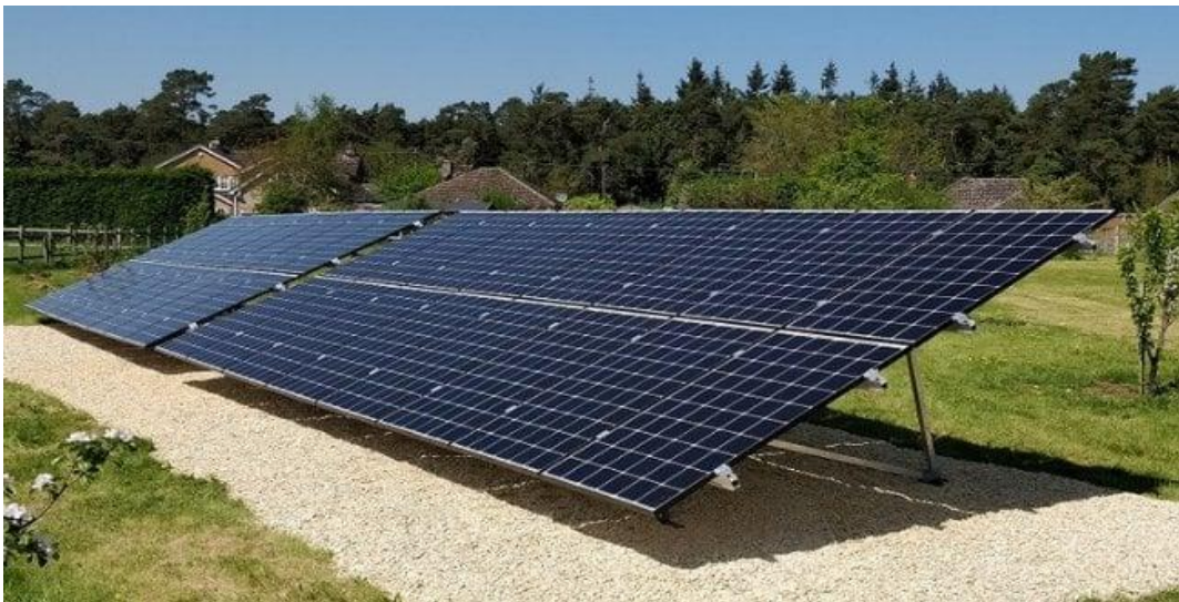
Figura 48 - Sistema de montagem no solo. (Riley, 2021)
