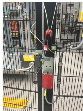
Figura 57 – Bloqueio de acesso ao interior da Paletizadora.
