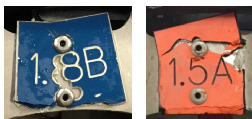
Figura 77 – Placas quebradas da Enchedora.
