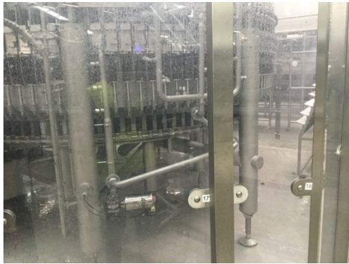
Figura 75 – Numeração das placas de policarbonato (Enchedora).
