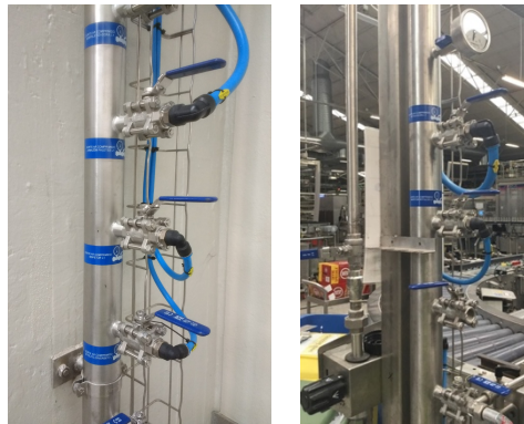
Figura 55 – Sinalização para corte pneumático (ar comprimido).
