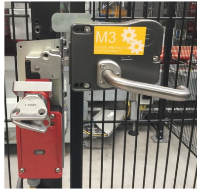
Figura 54 – Sinalização para bloqueio de acesso ao interior da máquina.
