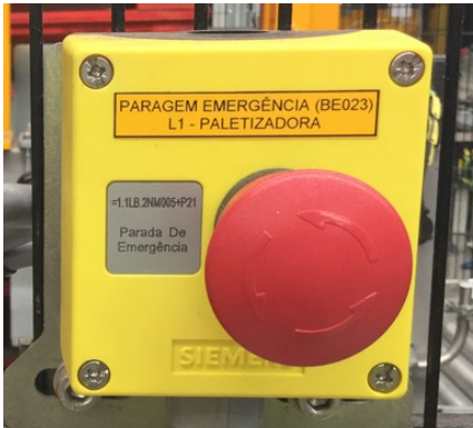
Figura 53 – Botoneira de emergência.
