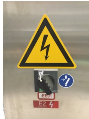
Figura 56 – Sinalização para corte de energia.
