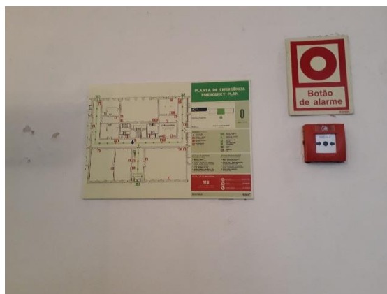
Figura 31. Equipamento de alarme, MTCAP.
