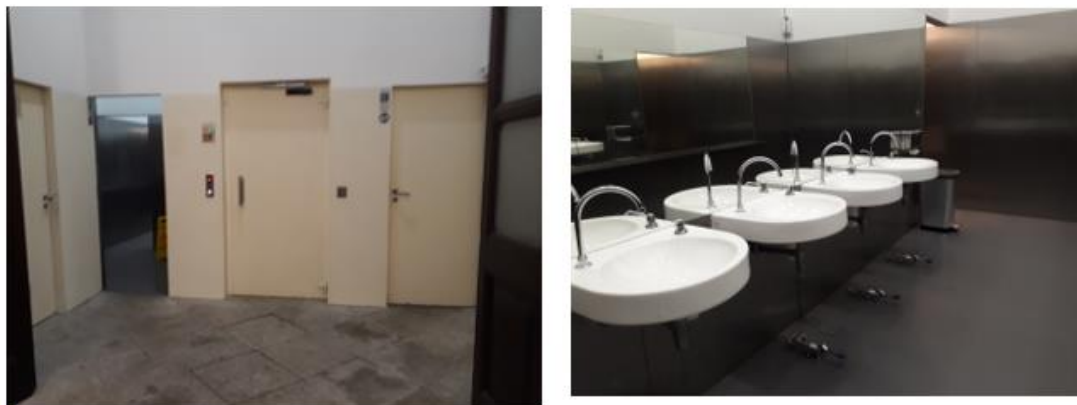
Figura 74. Portas com alavanca e torneiras manuais, MTCAP.
