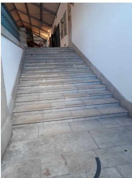
Figura 65. Ausência de sinalização nas escadas, MTCAP.
