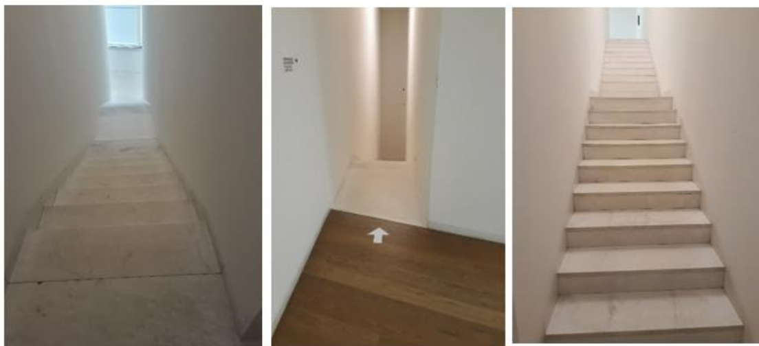
Figura 70. Ausência de iluminação e de sinalização nas escadas, MACS.
