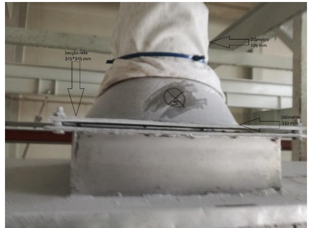
Figura A. 44 - Captação LS10B1, no transportador sem-fim de distribuição para os classificadores (TRSF 0029)
