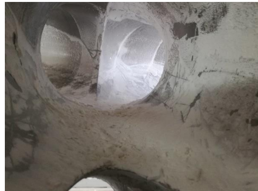
Figura A. 55 - Bifurcação da linha principal após a limpeza, na perspectiva da linha principal de aspiração
