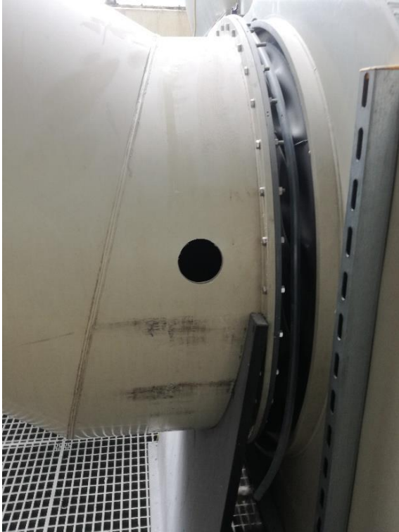
Figura A. 67 - Ponto de medição da velocidade do ar na admissão do ventilador
