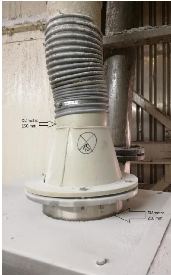
Figura A. 34 – Captação LS4, no transportador sem fim para o elevador dos classificadores (TRSF 0171)
