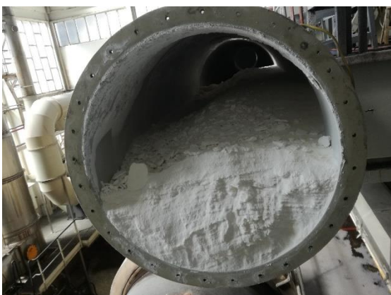
Figura A. 48 - Interior da conduta a jusante das ramificações LS3 e LS4
