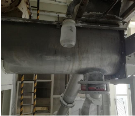
Figura A. 19 - Representação do ponto de transferência entre o TRSF 0051 e o TRSF 0004 (Transportador sem fim para elevador da torre)
