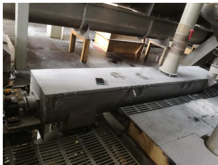
Figura A. 4 - Transportador sem-fim de descarga para silo de 70 ton (TRSF 0048)
