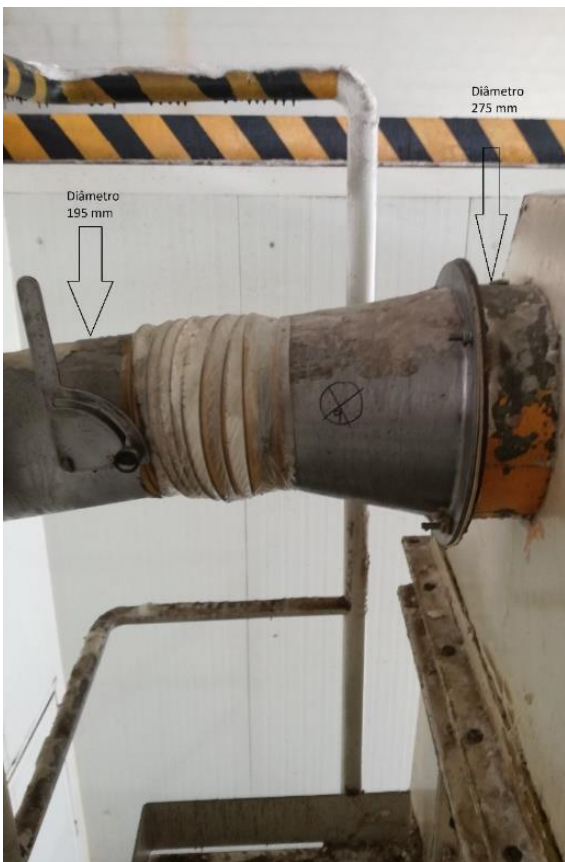
Figura A. 39 – Captação LS8 no elevador para silo de 75 ton (ELVE 0014)
