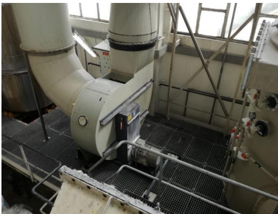
Figura A. 22 - Fotografia do ventilador e transição para a chaminé
