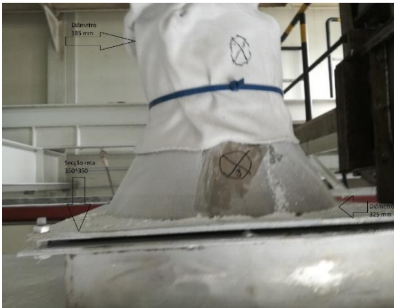
Figura A. 42 - Captação LS10A2, no transportador sem-fim de distribuição para os classificadores (TRSF 0029)
