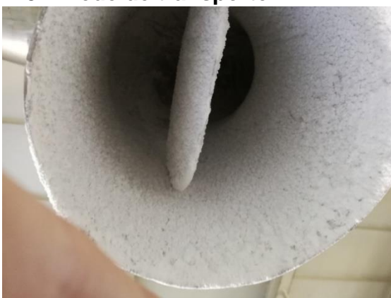
Figura A. 47 - Válvula borboleta no interior do ramal LS10A2
