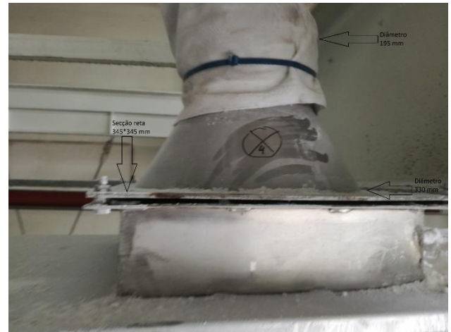
Figura A. 40 - Captação no transportador sem-fim de distribuição para os classificadores (TRSF 0029)
