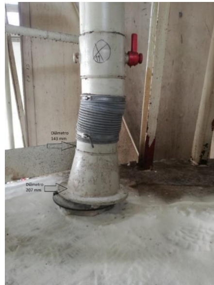
Figura A. 31 - Captação LS2B, no topo do silo de 70 ton (SILO 0031)
