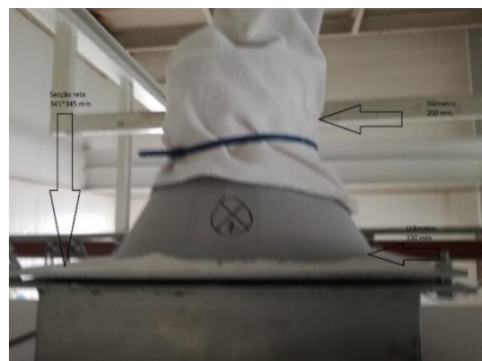
Figura A. 46 - Captação LS10B3, no transportador sem-fim de distribuição para os classificadores (TRSF 0029)
