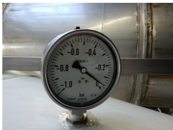
Figura A. 60 - Vacuómetro WIKA instalado a montante do ventilador
