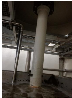
Figura A. 24 - Descarga de águas doces para o tanque de lavagem da estação de tratamento
