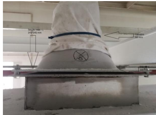
Figura A. 45 - Captação LS10B2, no transportador sem-fim de distribuição para os classificadores (TRSF 0029)
