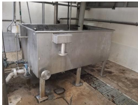
Figura A. 25 - Fotografia do tanque de lavagem da estação de tratamento
