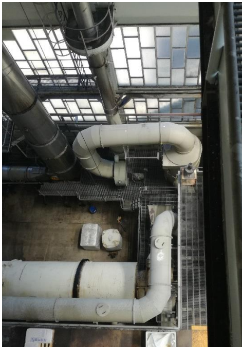
Figura A. 27 - Fotografia do sistema de recuperação do Despoeiramento Geral da Refinaria e da conduta principal
