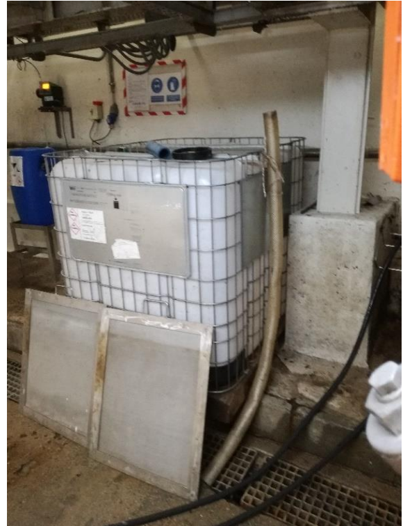
Figura A. 68 - Depósito usado para a determinação do caudal de águas doces recirculadas para a câmara de lavagem
