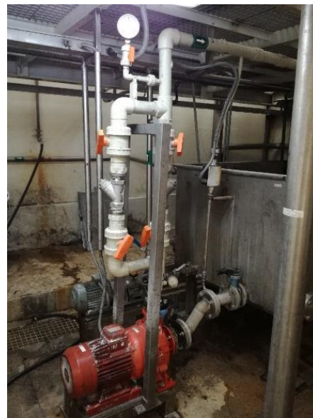
Figura A. 26 - Fotografia da bomba de recirculação de águas doces para a câmara de lavagem (vermelha) e da bomba que envia águas doces para as destrojadoras (cinzenta)
