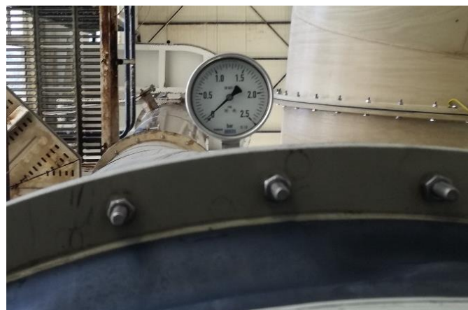
Figura A. 59 - Manómetro WIKA instalado a jusante do ventilador
