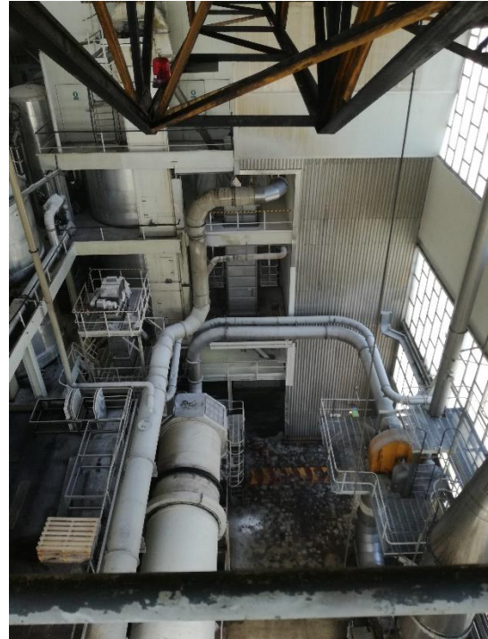
Figura A. 28 - Progressão da conduta principal até à Sala dos Classificadores
