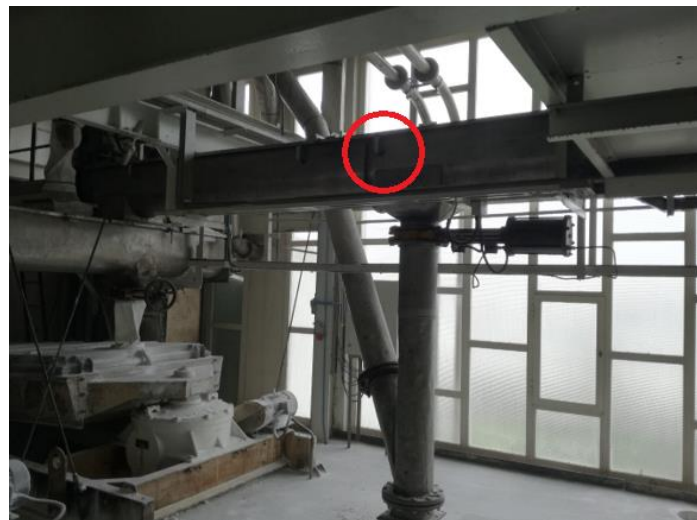
Figura A. 17 - Transportador sem-fim de descarga no elevador dos classificadores (TRSF 0045)
