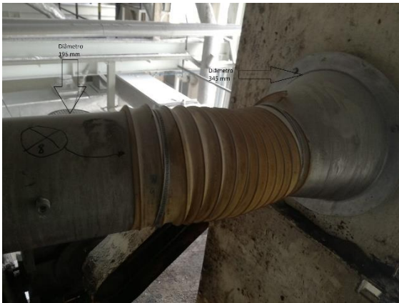
Figura A. 38 – Captação LS7 no elevador para classificadores (ELVE 0012)
