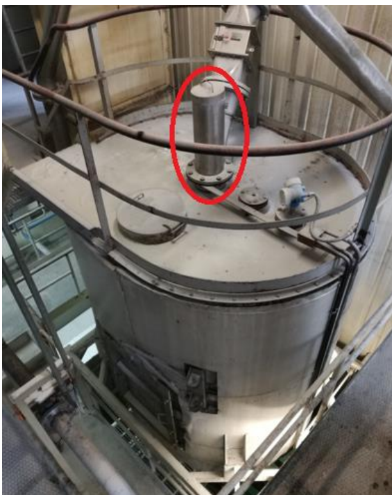
Figura A. 16 - Silo de pó e troças de 10 ton (SILO 0038)
