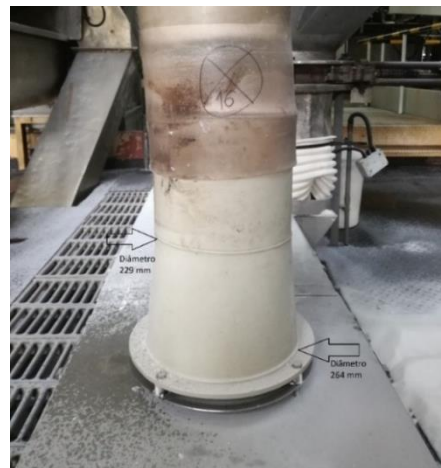
Figura A. 32 – Captação LS3A, no transportador sem-fim de descarga para o silo de 70 ton (TRSF 0048)
