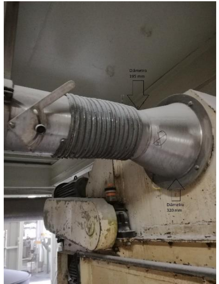
Figura A. 36 – Captação LS6A, no elevador de açúcares especiais (ELVE 0015)
