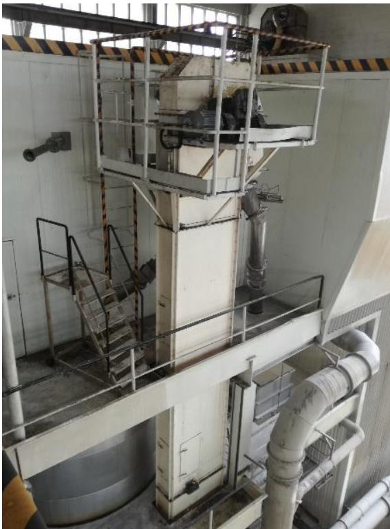
Figura A. 10 - Elevador para Silo 75 ton (ELVE 0014)
