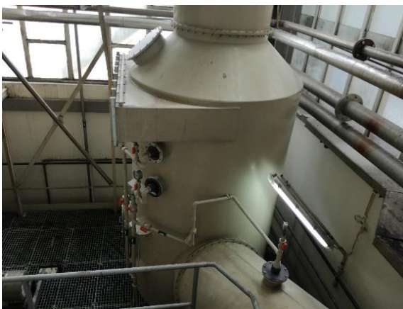
Figura A. 23 - Fotografia da câmara de lavagem
