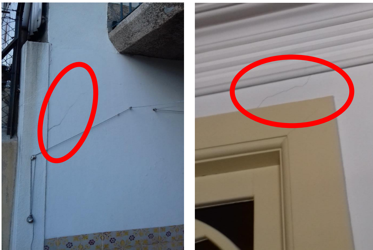
Figura 4.14 – Abertura de fissuras no edifício vizinho.
