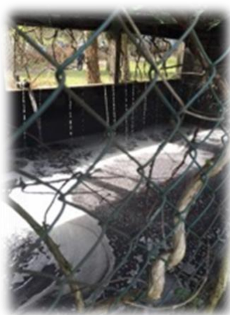
Figura 3-8 Tanque 1, tanque onde o efluente é recebido e homogeneizado
