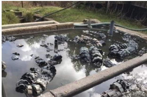
Figura 3-13 Leitos percoladores existentes ao longo do tratamento secundário
