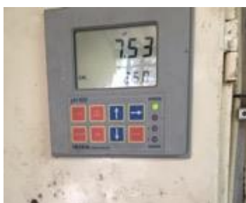
Figura 3-11 Medidor de pH contínuo
