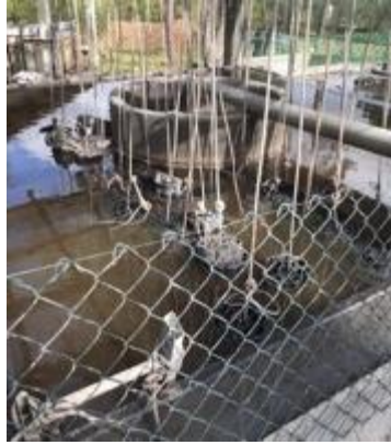
Figura 3-12 Tanques 4 e 5, estágios finais do tratamento primário
