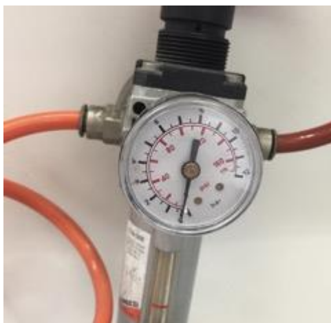
Figura 5-17 Regulador de pressão de ar comprimido aplicado no arejamento
