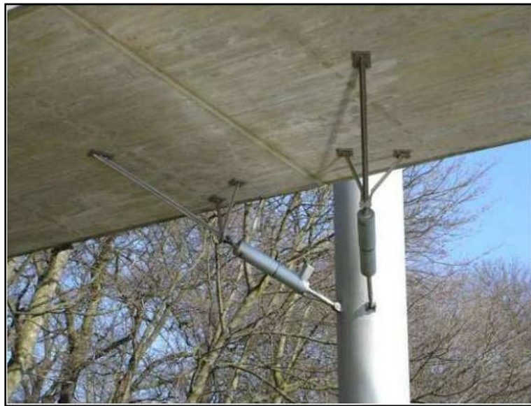
Fig.3.2. – Amortecedores de fluido viscoso instalados na ponte pedonal de Minden [15]
