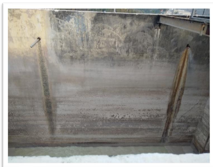
Figura 30 – Corrosão numa das paredes do tanque de arejamento.
