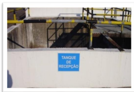
Figura 26 – Tanque de receção.
