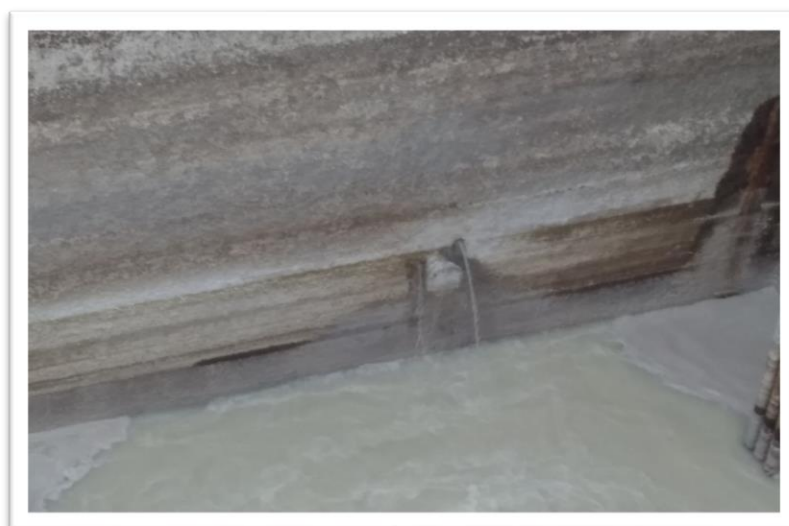
Figura 31 – Infiltração na parede entre os tanques de receção e arejamento.
