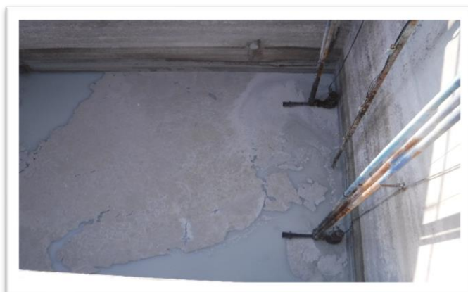
Figura 28 – Injetores de ar atmosférico existentes no tanque de arejamento.
