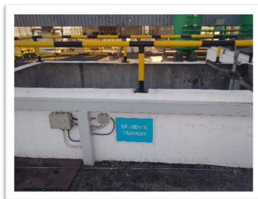
Figura 38 – Tanque de efluente tratado.
