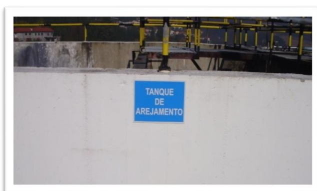
Figura 27 – Tanque de arejamento.
