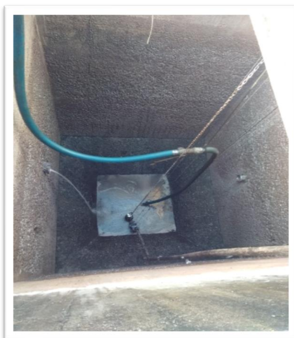
Figura 29 – Corrosão no fundo e paredes do tanque de recepção.
