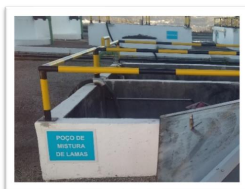
Figura 39 – Tanque de alimentação ao filtro prensa (poço de mistura de lamas).
