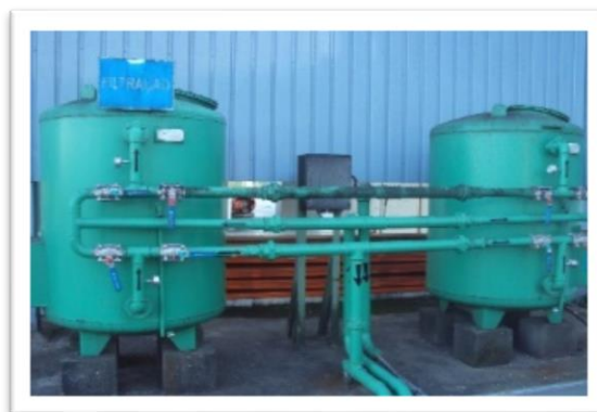
Figura 37 – Filtros de Areia.
