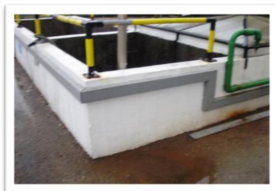
Figura 36 – Tanque de alimentação aos filtros de areia.
