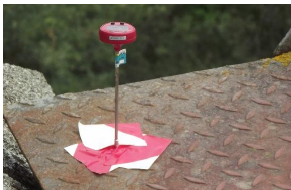
a) Termómetro na estrutura
