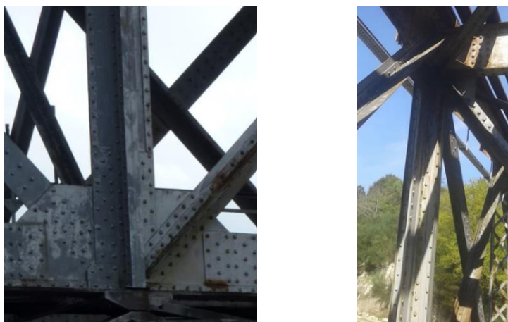
a) Pormenor do reforço da extremidade inferior b) Vista pelo interior do tabuleiro
