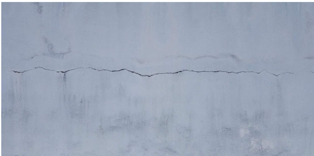
Figura 6-2 – Imagem 1 (Original, Fissuras, Edifício F)
