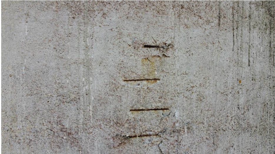
Figura 6-33 – Imagem 5 (Original, Armaduras expostas, Edifício industrial)
