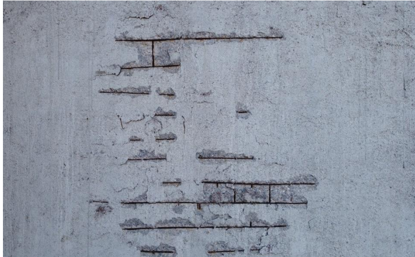
Figura 6-24 – Imagem 2 (Original, Armaduras expostas, Edifício industrial)
