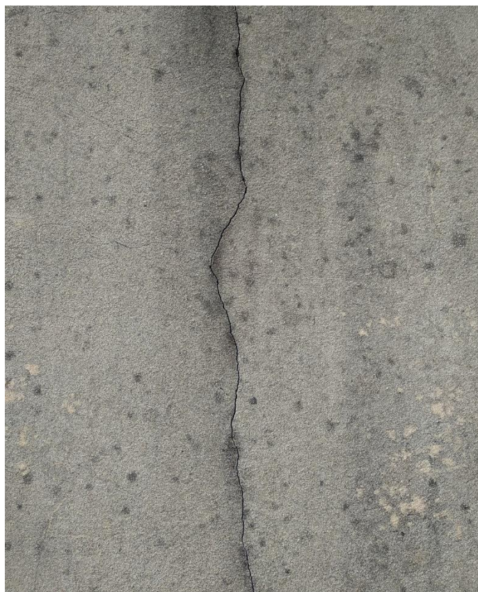
Figura 6-9 - Imagem 2 (Original, Fissuras, Unidade Hoteleira)
