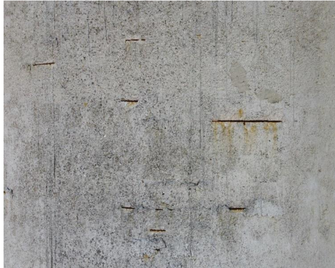
Figura 6-39 – Imagem 7 (Original, Armaduras expostas, Edifício industrial)
