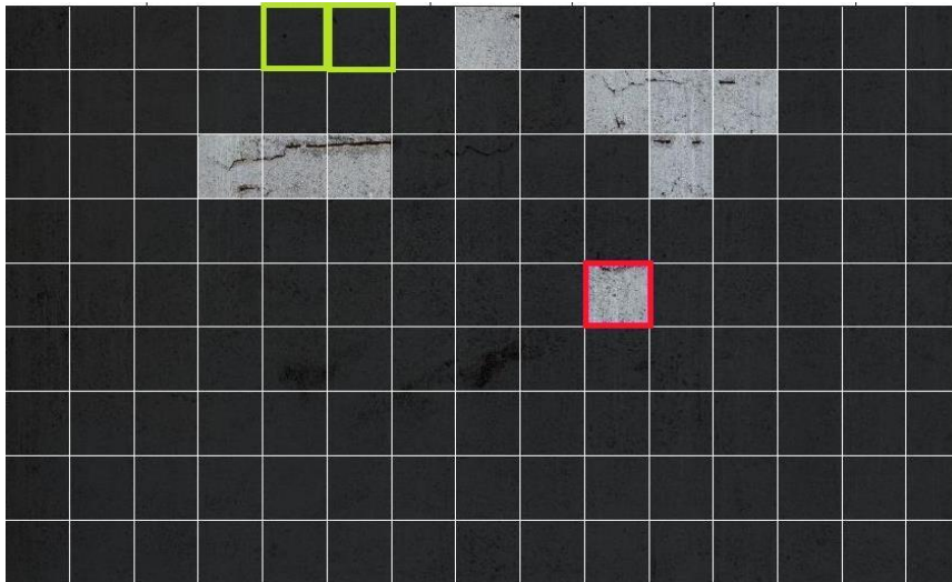
Figura 6-28 – Imagem 3 (Abordagem 1 (RNC), Armaduras expostas, Edifício industrial)
