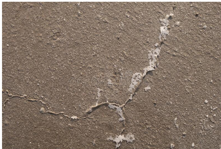
Figura 2-13 – Fissuras devido a cristalização de sais (Dreamstime, 2020)
