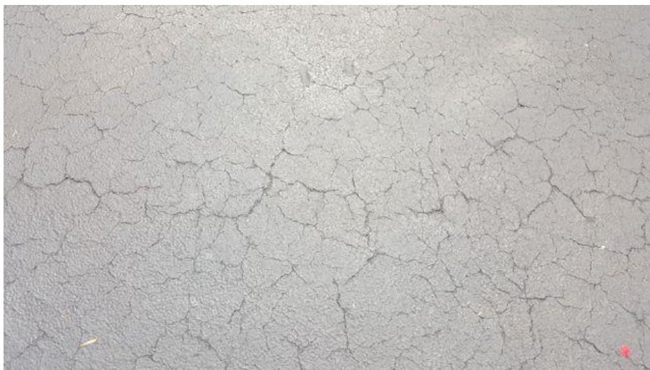
Figura 2-5- Fissuras por retração plástica (Constrofacilator, 2020)
