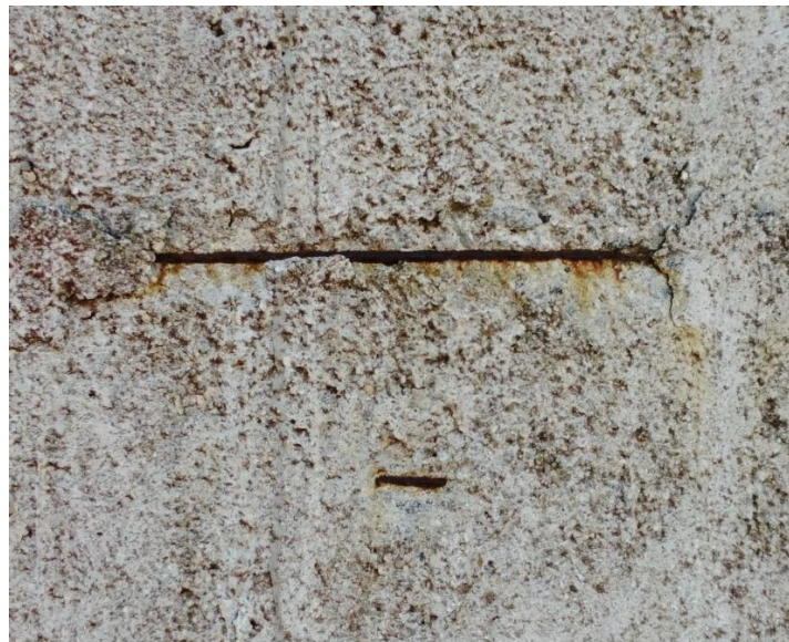
Figura 2-15 – Armadura exposta por destacamento do betão de recobrimento
