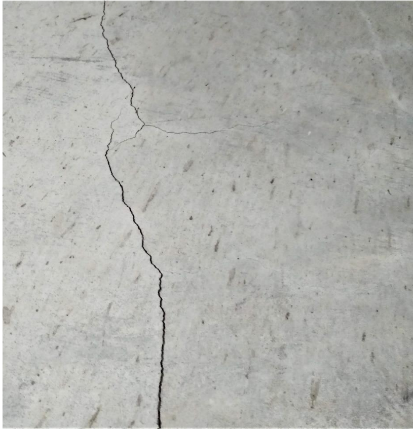
Figura 6-7 – Imagem 1 (Original, Fissuras, Unidade Hoteleira)
