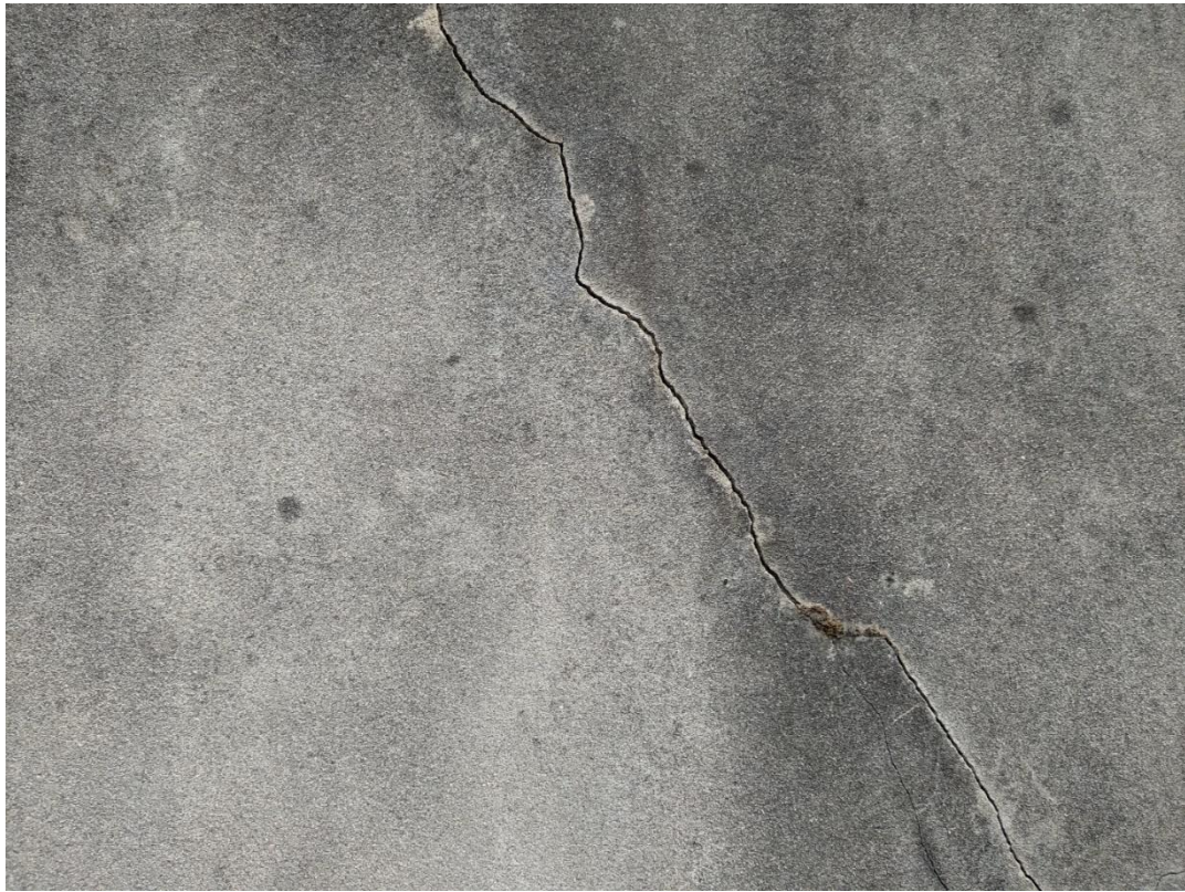
Figura 6-11 - Imagem 3 (Original, Fissuras, Unidade Hoteleira)
