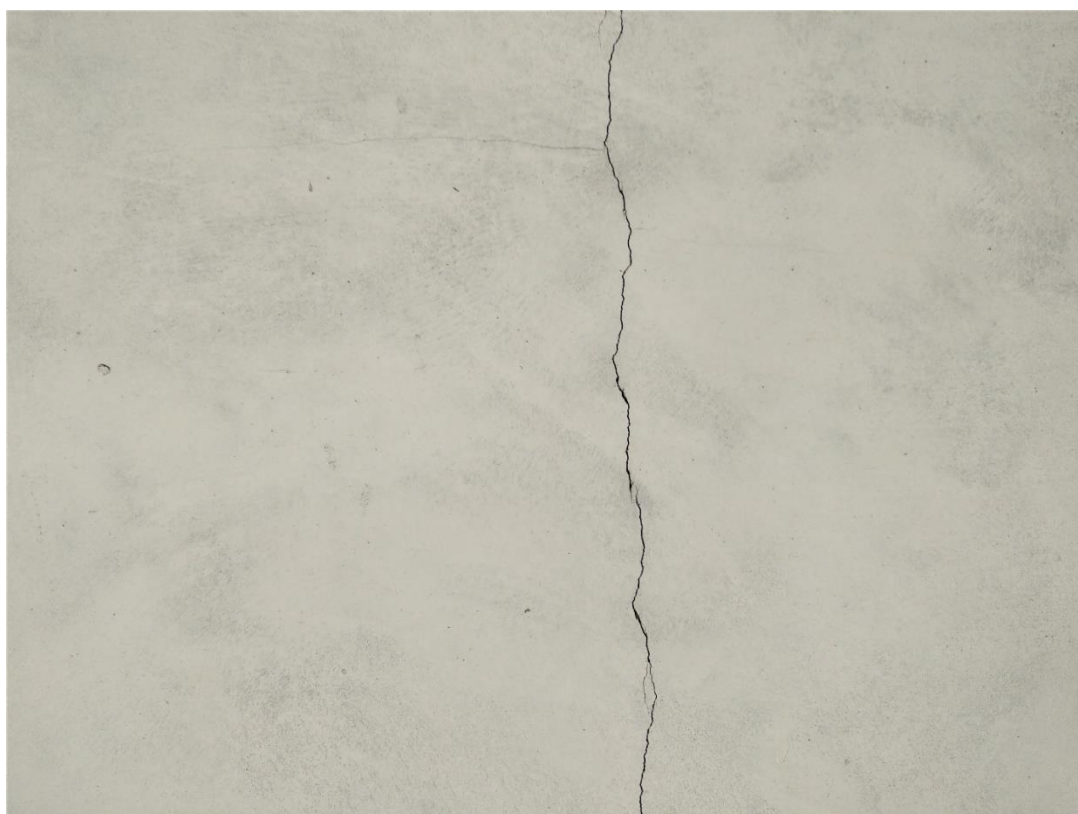
Figura 6-13 - Imagem 4 (Original, Fissuras, Unidade Hoteleira)
