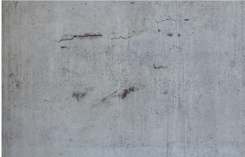
Figura 6-27 – Imagem 3 (Original, Armaduras expostas, Edifício industrial)
