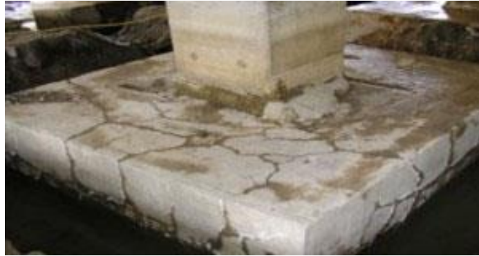
Figura 2-12 – Fissuração devido a reação alcalis-sílica (BlogLPE, 2020)
