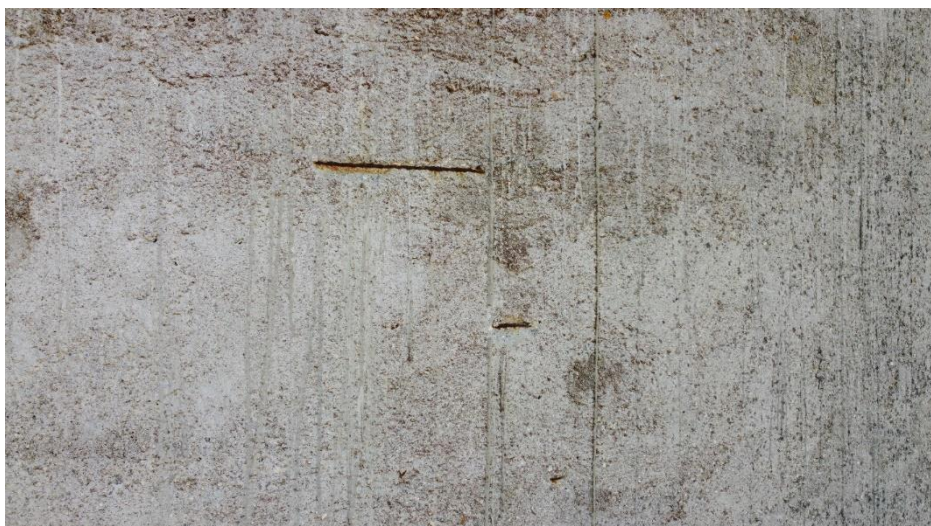
Figura 6-30 – Imagem 4 (Original, Armaduras expostas, Edifício industrial)
