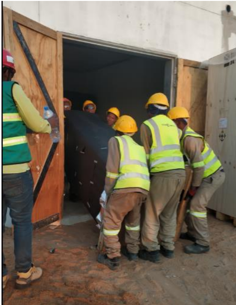
Figura 91: Movimentação de cargas de forma indevida
