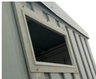
Figura 76: Compartimento exterior de passagem de cabos
