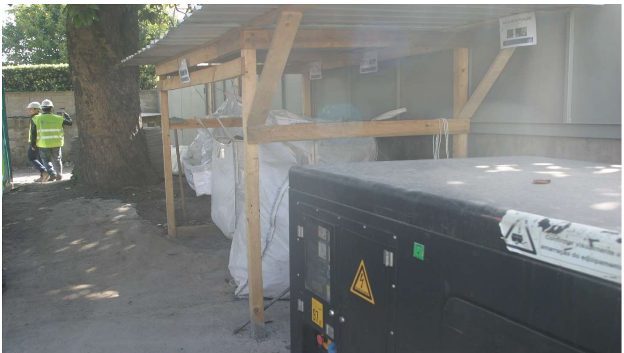
Figura 3.6 – Zona de reciclagem
