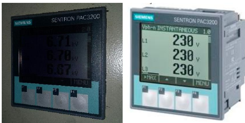
Figura 46 Contador de energia elétrica para a fábrica (foto da instalação e imagem de catálogo).
