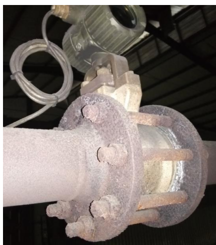
Figura 40 - Contador de vapor saturado para a fábrica
