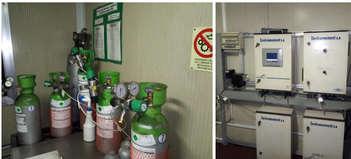
Figura 43 Sala com medidores de gases e botijas de calibração.
