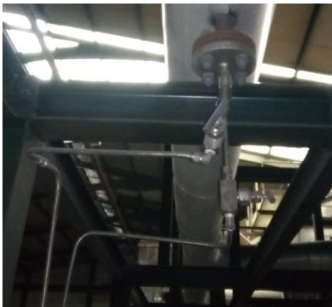
Figura 41 Pormenor das tomadas de pressão do tubo Pitot do contador de vapor a 4,0 MPa
