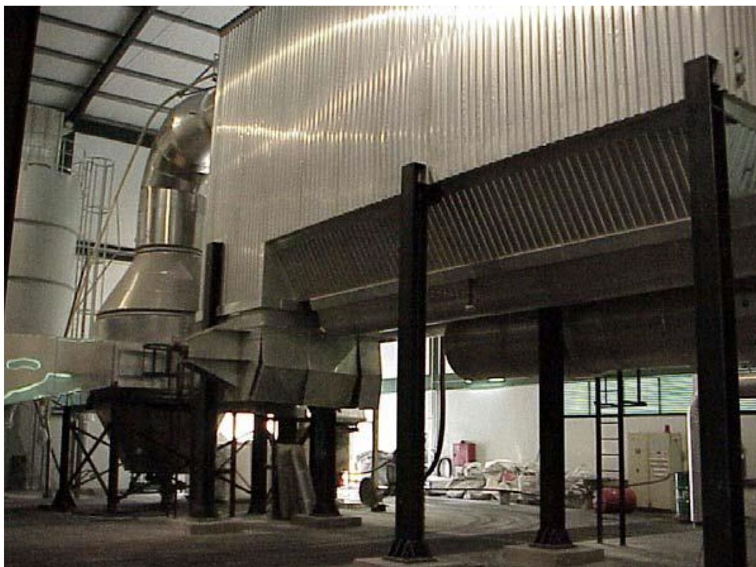
Figura 31 Ciclone e filtros manga (arquivo da empresa).
