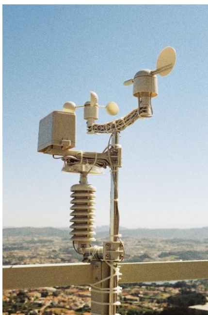
Figura 4.4 – Estação meteorológica instalada na torre do Monte da Virgem.
