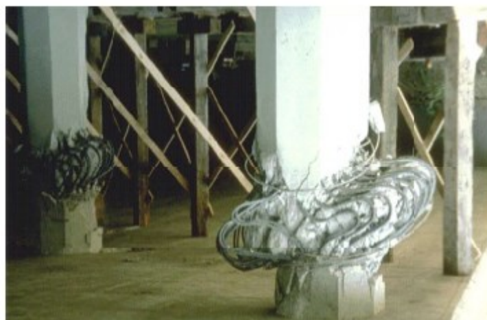
Figura 4-8 - Exemplo de rotura plástica
