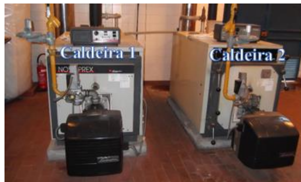
Figura 7.23 – Caldeiras a gás natural utilizadas no Lar “A”.
