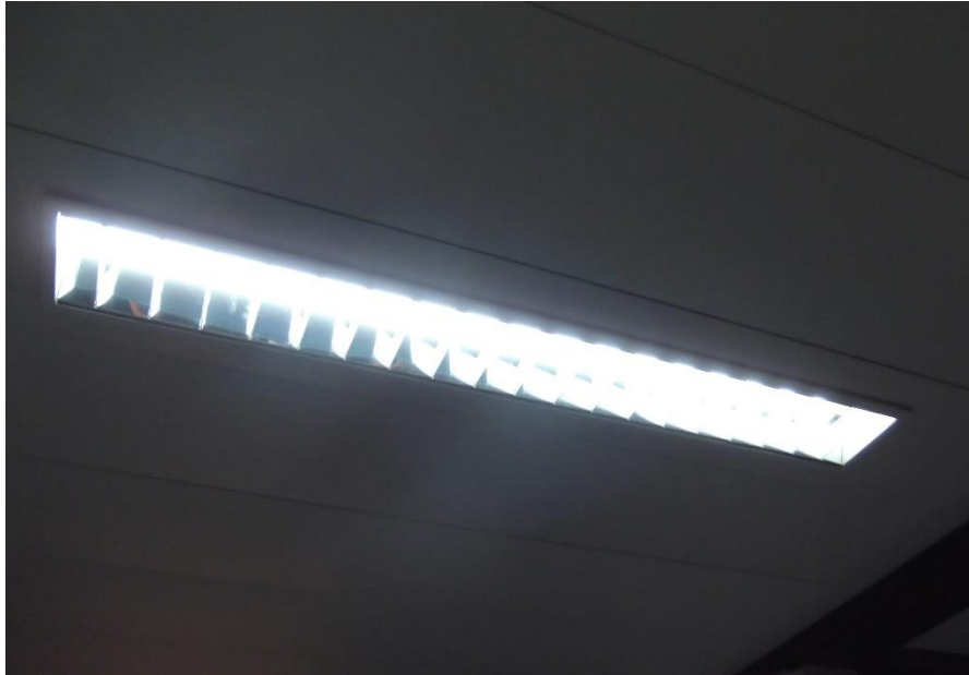
Figura 7.13 – Luminárias de encastrar para lâmpadas fluorescentes utilizadas.
