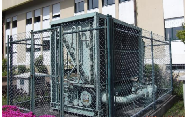
Figura 7.22 – Chiller utilizado no Lar “A”.
