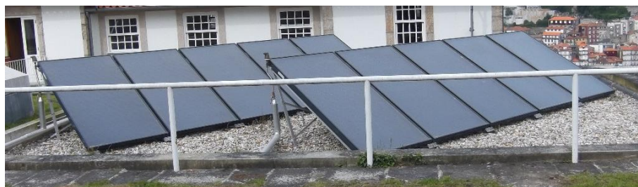
Figura 7.90 - Painéis solares instalados no Lar "C".
