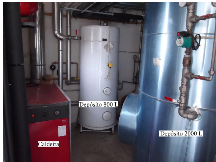
Figura 7.89 - Aspeto do interior da central térmica - Lar "C".
