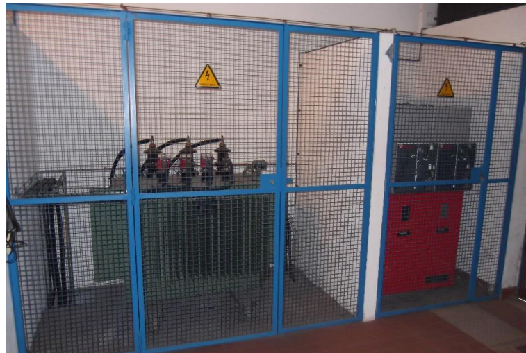
Figura 7.7 – Transformador utilizado e respetivo compartimento – Lar “A”.
