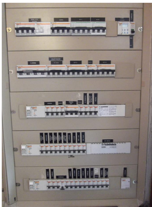
Figura 7.84 – QGBT do edifício C.
