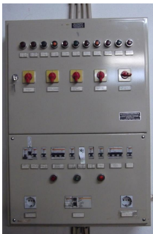
Figura 7.67 – Quadro elétrico do sistema de AVAC do Lar “B”.
