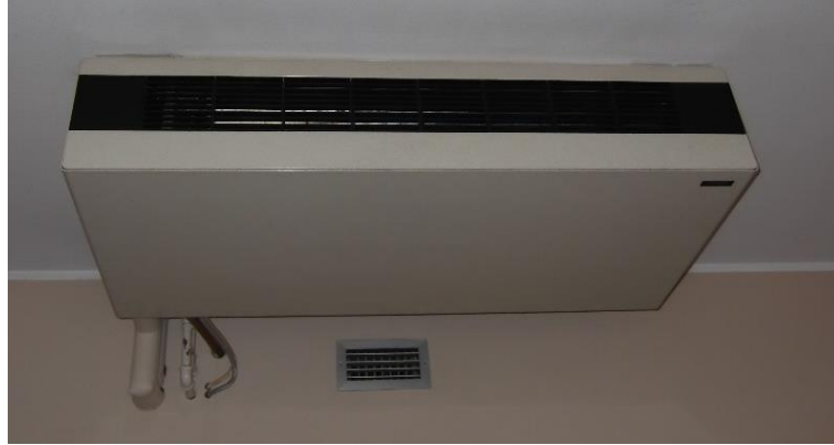
Figura 7.25 – Ventiloconvetor fixo no teto.
