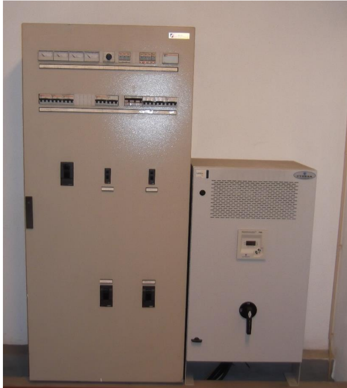
Figura 7.8 – QGBT e quadro elétrico para compensação do fator de potência.
