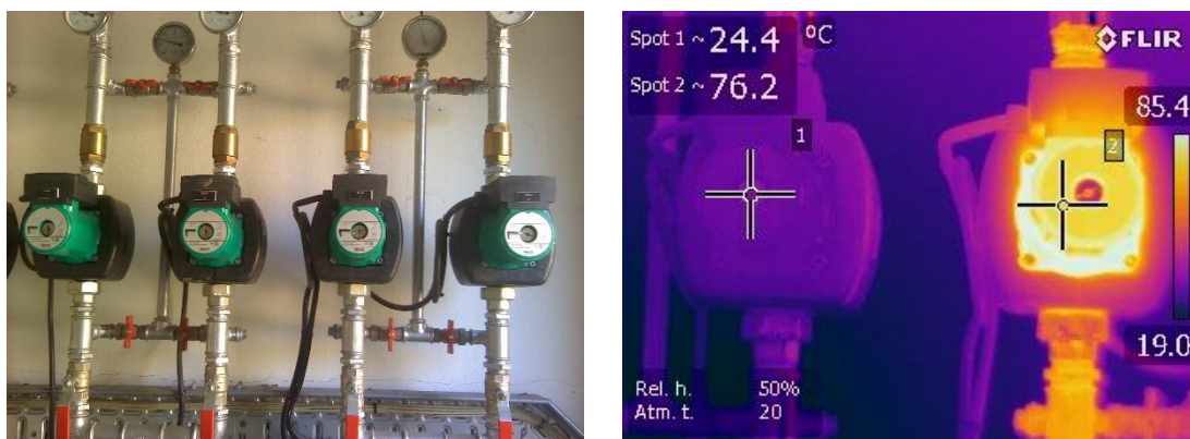
Figura 7.99 – Registo digital (à esquerda) e térmico (à direita) de uma bomba circuladora.
