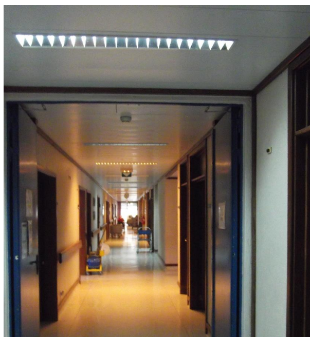
Figura 7.16 – Iluminação utilizada nos corredores dos quartos – Piso 1.
