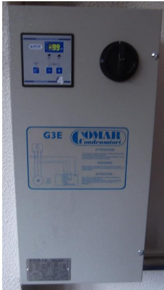
Figura 7.59 – Bateria de Condensadores do edifício B.
