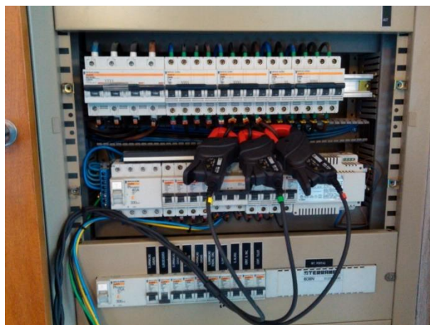
Figura 7.3 – Ligação das pinças amperimétricas do equipamento na saída de um disjuntor tetra polar.
