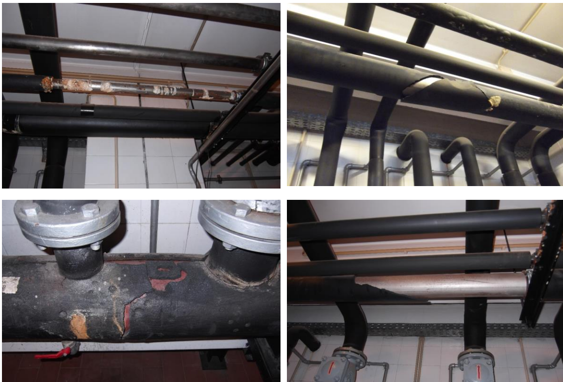
Figura 7.50 – Registos fotográficos de deficiências detetadas no isolamento térmico.
