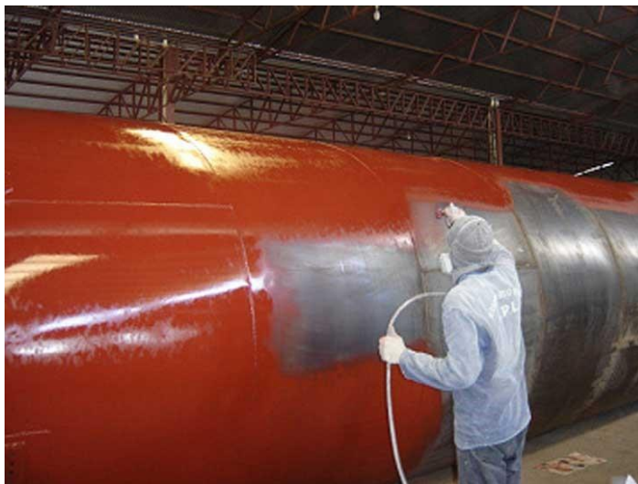
Figura 4.4 – Pintura de poliuretano
