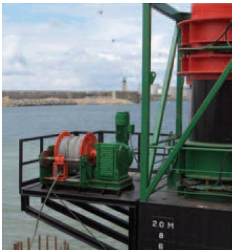
Figura 19 – Sistema de movimentação de plataforma flutuante implementado pela SEW-Eurodrive numa empresa do Grupo Mota-Engil [ www.sew-eurodrive.pt , 2012].
