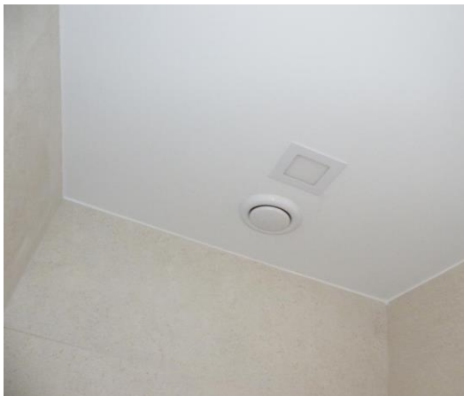
c) Ventilação no wc
