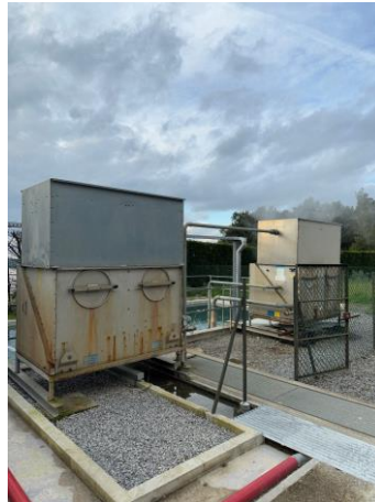
Figura 21 - Torres de arrefecimento.
