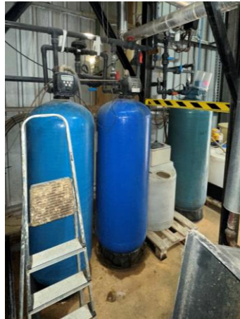
Figura 12 - Descalcificadores que equipam a linha de tratamento de água da Petibol.
