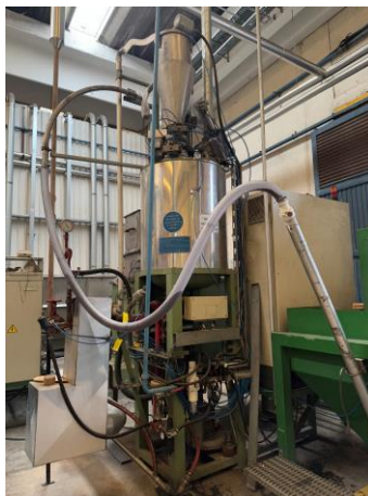
Figura 3 – Um dos três pré-expansores de EPS que integram a linha de produção dos moldados.
