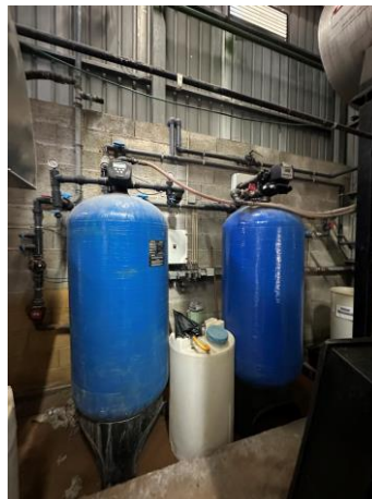
Figura 11 - Desferrizadores que equipam a linha de tratamento de água da Petibol.
