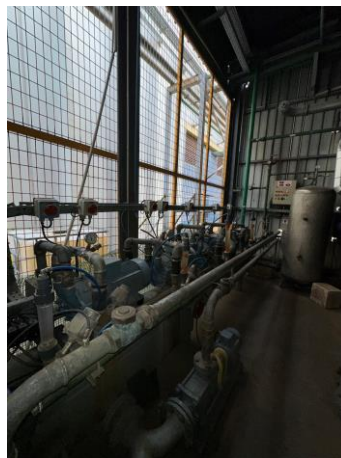
Figura 20 - Central de vácuo instalada na estação técnica.
