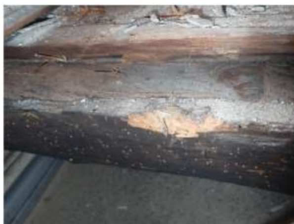
b) Estado de degradação (agentes bióticos)
