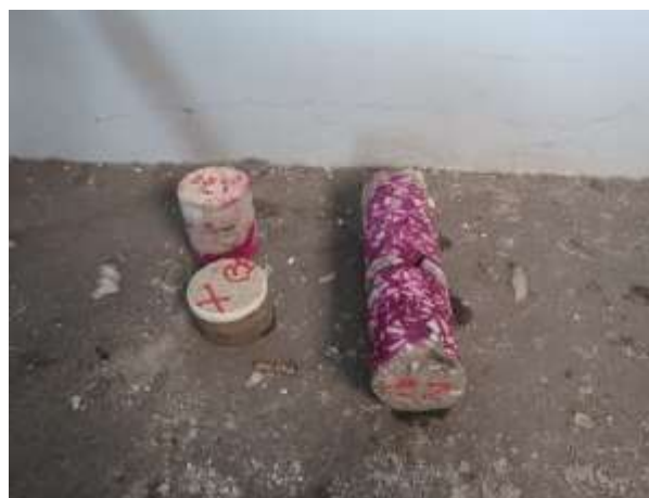
d) Carotes e ensaio de profundidade de carbonatação
