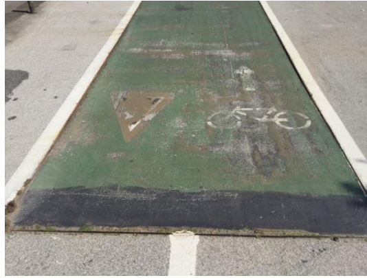
Figura 4.48 – Ponto 26: Coloração do pavimento começa a ser verde e possui partes desgastadas.
