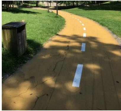
Figura 4.31 – Ponto 12: Fendilhamentos por efeito de raízes ou do próprio solo no pavimento da ciclovia.
