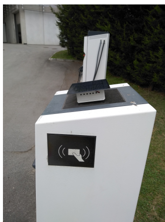
Figura 7.7: Caixa de Sensores Fixa instalada no posto de carregamento
