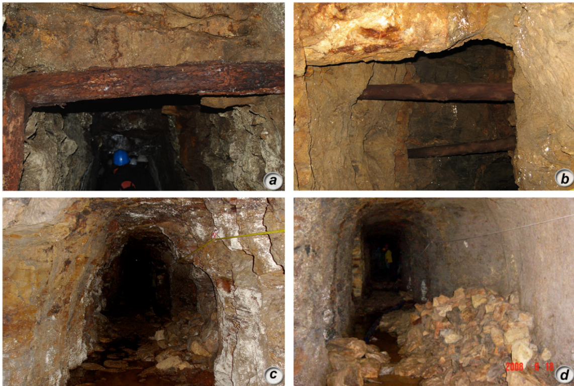
Figura 69. Exemplos do estado de degradação dos suportes de madeira (com mais de 50 anos) da mina das Aveleiras (a, b) e aspetos de locais de abatimento pontual nas galerias da mina das Aveleiras (c, d). In: Lopes (2012).
